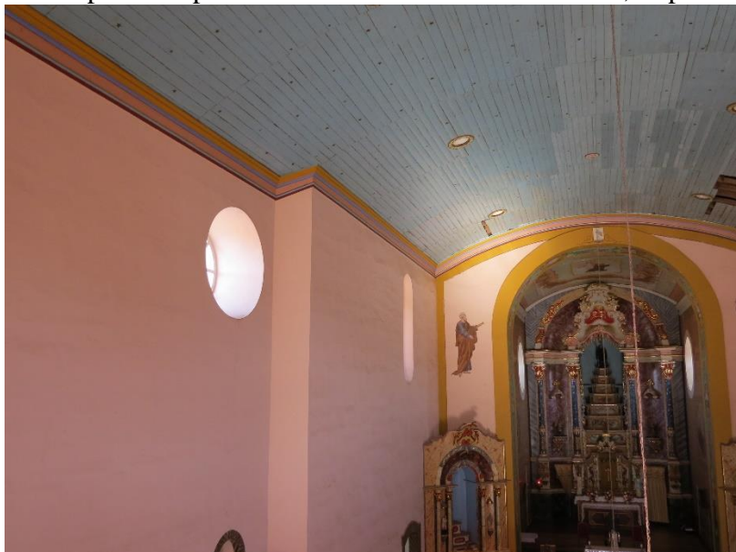
Figura 106: Aspecto da parede da nave. Matriz de São Bento, Itapecerica, MG.
