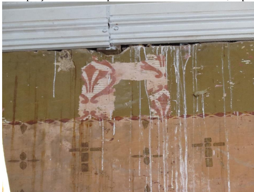
Figura 127: Prospecção. Parede da capela-mor. Matriz de São Bento, Itapecerica, MG.
