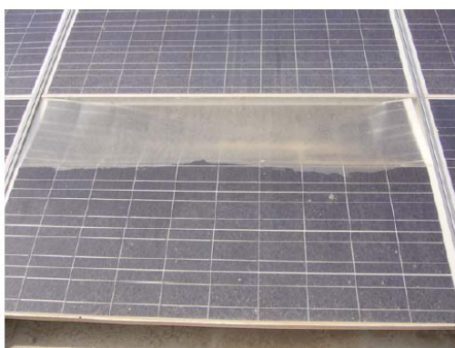
Figura 2.12. Delaminação no módulo fotovoltaico.
