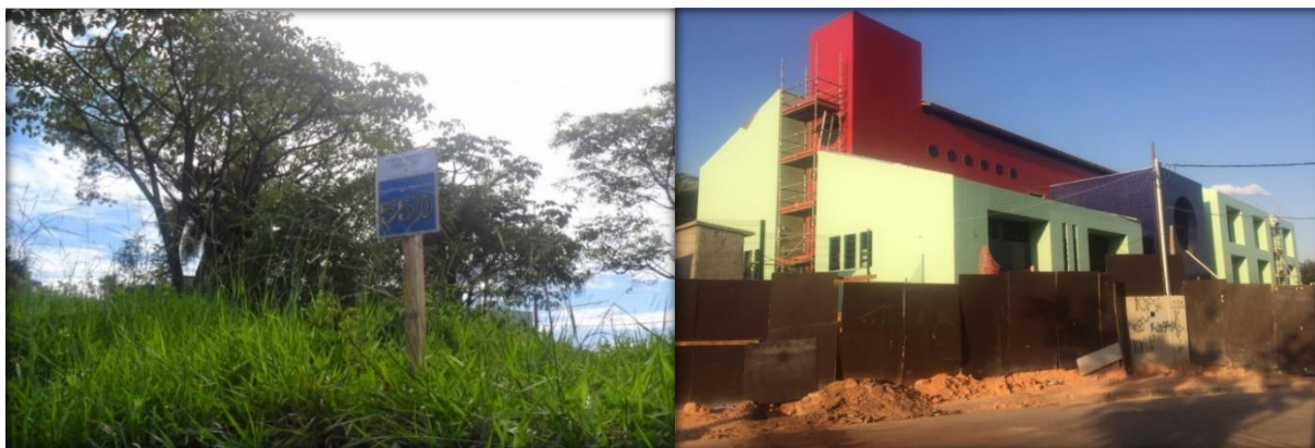
Figuras 5 e 6 - Espaço onde foi construída a EMEI e EMEI em construção. Fonte: Dados obtidos dos arquivos da gestão da EMEI (Retrato da EMEI, 2017).
