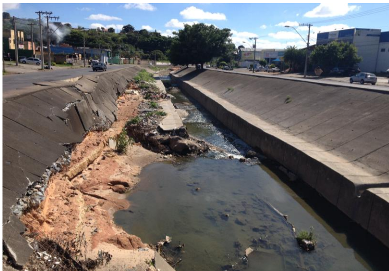
Figura 28: Erosão na margem do afluente do Córrego Ressaca
