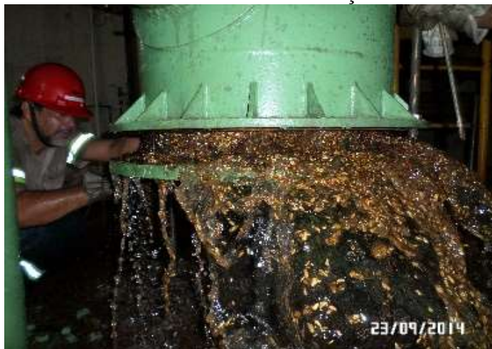
Figura 6 - Mexilhão dourado dentro de tubulação em usina hidrelétrica
