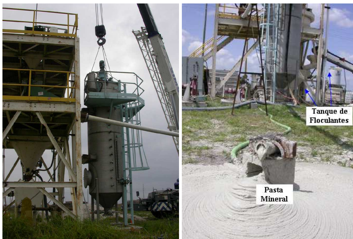
Figura 3.10: Instalação e Teste Operacional do Espessador Piloto Eimco Deep Cone. (D.Tão et al, 2008)
