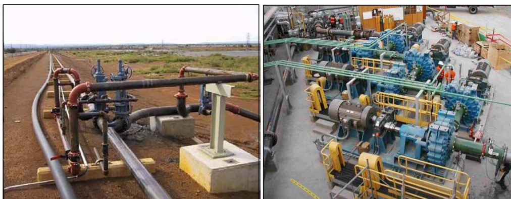
Figura 3.6: Sistema de tubulações e bombas de deslocamento positivo utilizados para o transporte de pasta de rejeitos. (Therriault, 2001)
