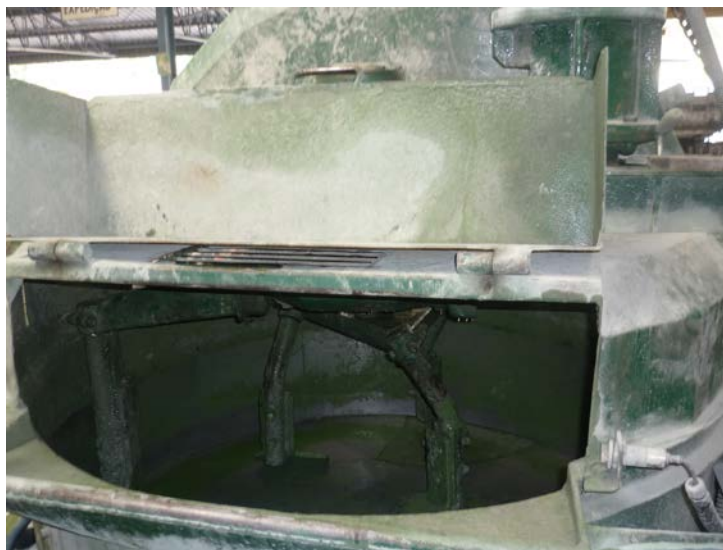
Figura 3.58 – Vista interna do misturador Eirich.
