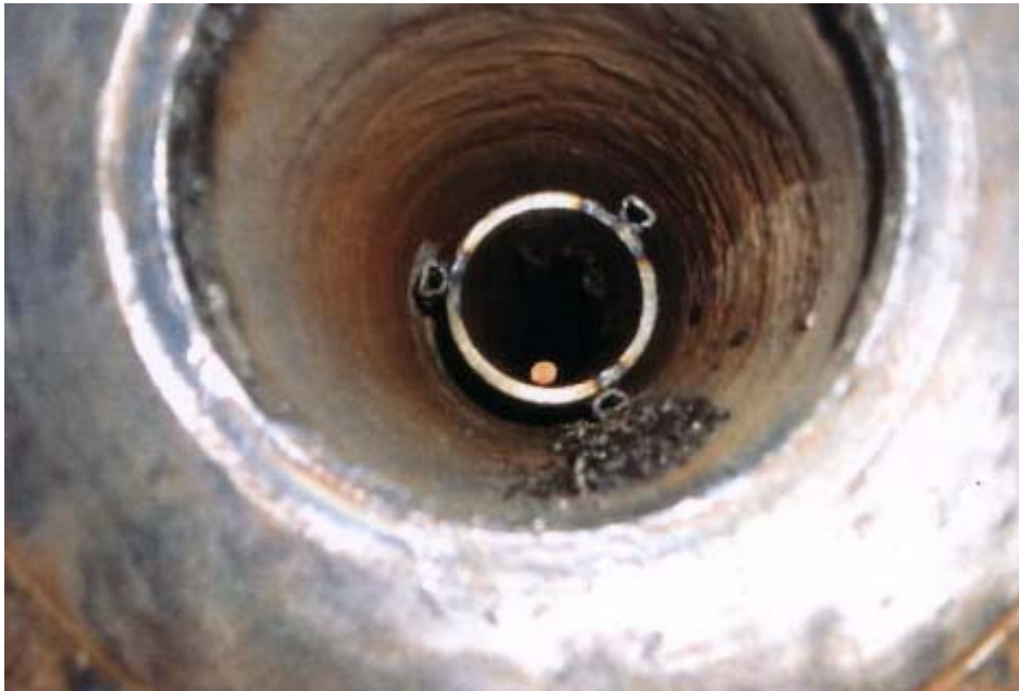
Figura 41: Corrosão interna do tubo de selagem
