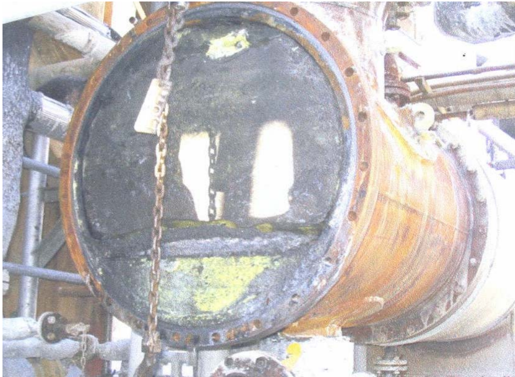
Figura 53: Acúmulo de enxofre solidificado em toda seção interna do carretel
