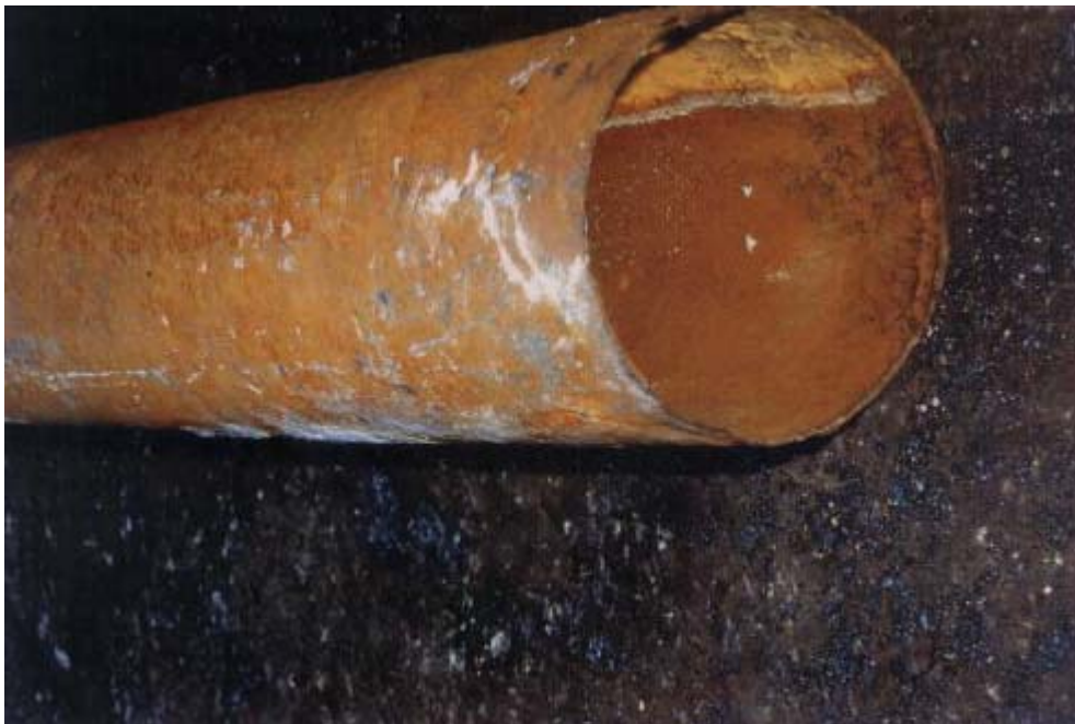
Figura 43: Processo corrosivo severo em um ponto localizado internamente ao flange
