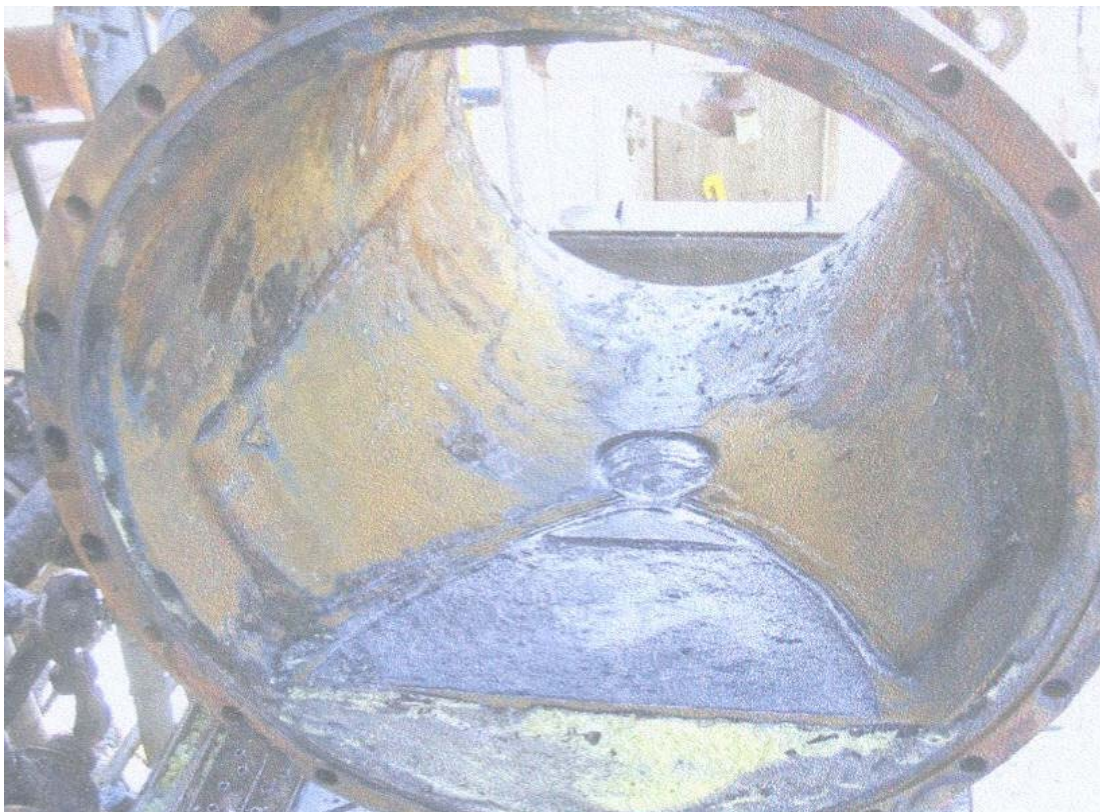
Figura 54: Inspeção visual interna na chapa do carretel
