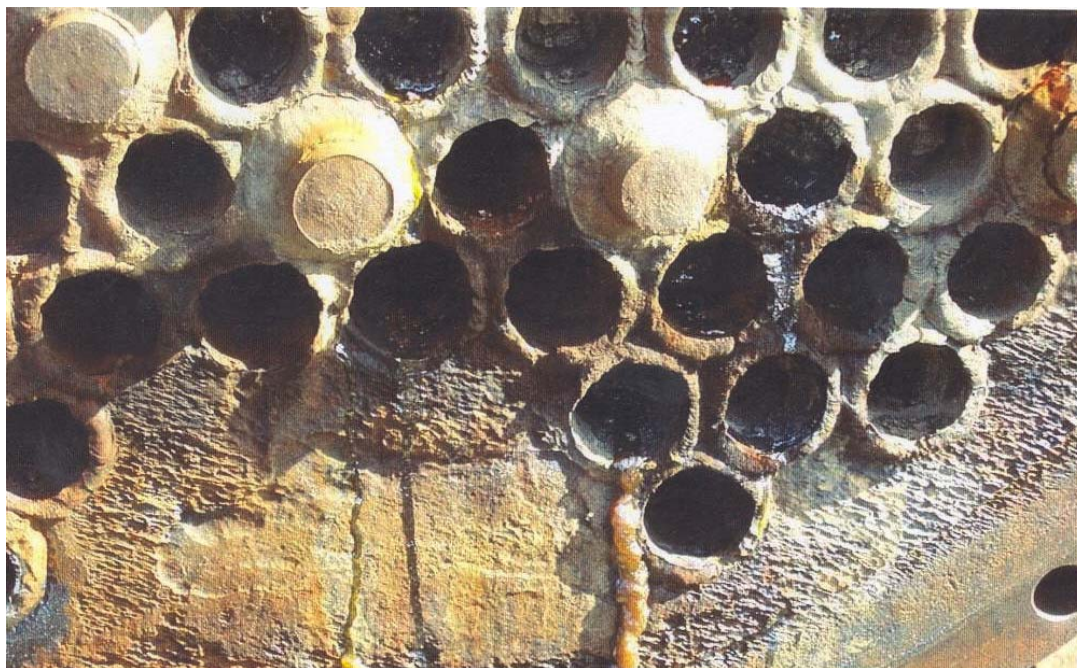
Figura 33: Corrosão inferior do espelho do lado do carretel
