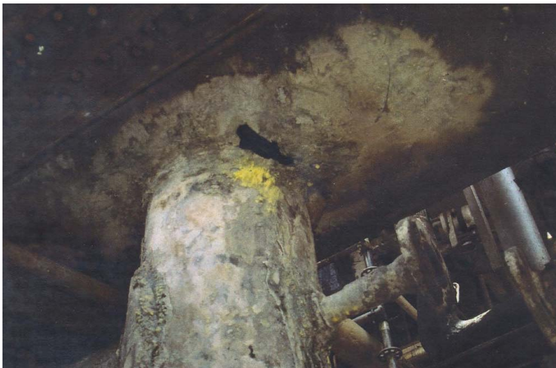
Figura 37: Corrosão severa no trecho inferior do carretel
