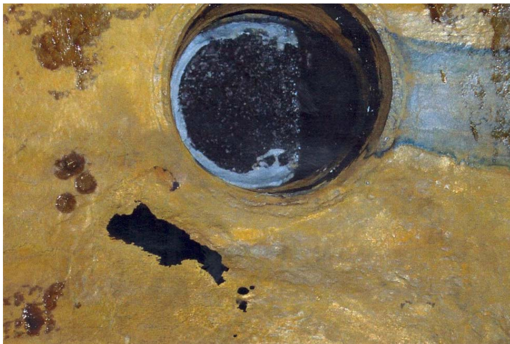
Figura 38: Furo comunicante da camisa de vapor da bota
