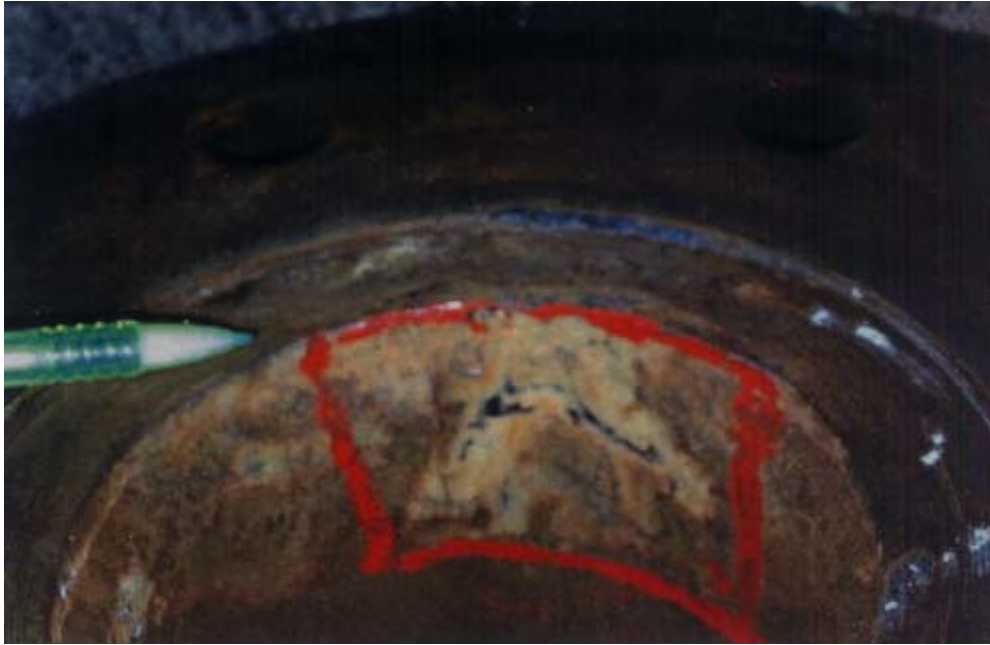
Figura 42: Perda de espessura no cordão de solda da extremidade inferior do tubo interno da camisa de vapor
