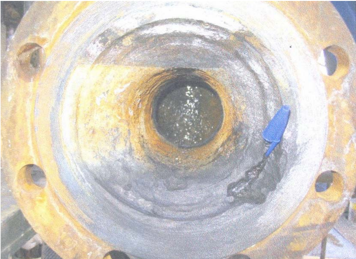
Figura 55: Trinca na solda entre a linha de enxofre e a camisa de vapor
