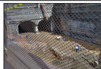
Figura 48: Foto do buraco do metrô de Salvador Fonte: arquivo pessoal. Foto tirada em 19/07/2006-Salvador/Ba
