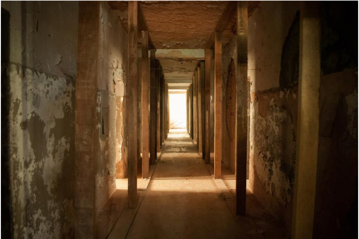
Figura 6: Segundo andar do casarão, já com escoramento. Foto retirada do Projeto de Restauração do ECLE (2015)
