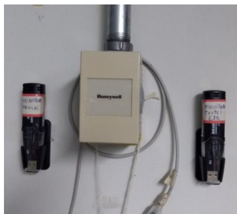
Figura 22 - Aparelhos registradores HIKARI utilizados pelos funcionários da RT para a coleta de dados de UR e T. Na imagem à esquerda uma foto do aparelho e na imagem à direita seu posicionamento dentro da RT ao lado do sensor do sistema de climatização. Foto: Christiane Santos.
