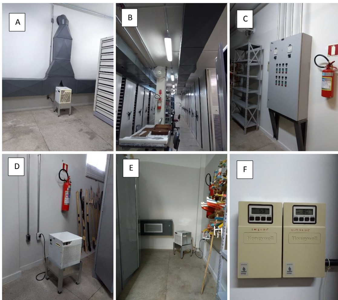
Figura 18 - Instalações do sistema de climatização da Reserva Técnica Curt Nimuendajú. A) Desumidificador e exaustor. B) Dutos de ventilação no teto; C) Painel elétrico exclusivo do sistema de climatização; D) e E) desumidificadores; F) Visor do sistema que mostra os dados internos e externos de UR medidos. Fonte: Christiane Santos
