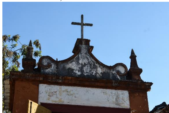
FIGURA 155 - Presença de fungos, bactérias e manchas no coroamento - Passo do Largo Ó, Tiradentes/MG
