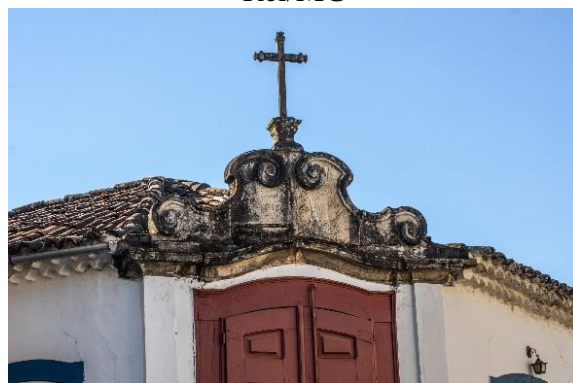
FIGURA 149 - Detalhes da presença de fungos, bactérias e manchas no coroamento do Passo do Largo da Cruz, São João del Rei/MG
