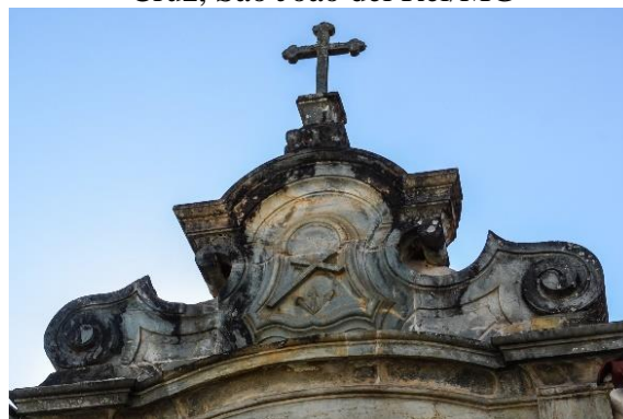
FIGURA 147 - Presença de fungos, bactérias e manchas no coroamento - Passo Largo da Cruz, São João del Rei/MG
