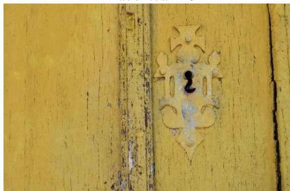
FIGURA 166 - Presença de fissura e esmaecimento da pintura - Passo Largo do Ó, Tiradentes/MG
