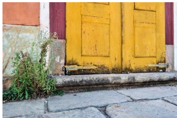
FIGURA 167 - Presença de manchas de umidades - Passo Largo do Ó, Tiradentes/MG
