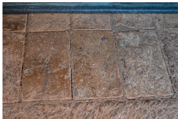
FIGURA 209 - Perda do rejunte e desgastes naturais no piso do Passo, em Tiradentes/MG.
