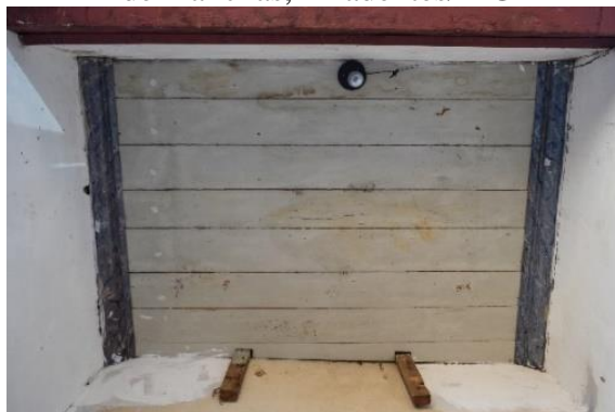
FIGURA 193 - Forro Largo do Ó e presença de manchas, Tiradentes/MG
