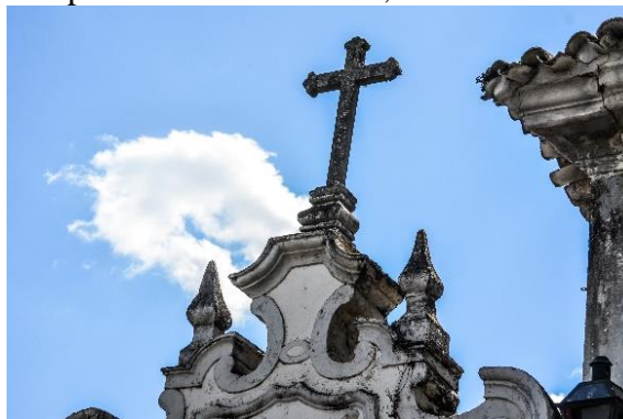
FIGURA 157 - Presença de danos no coroamento causados pela presença de água pluvial da edificação onde está inserida a Capela Passos da Mercês, Tiradentes/MG
