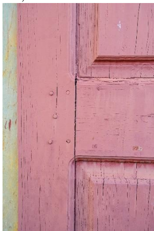
FIGURA 160 - Presença de fissuras e esmaecimento da pintura - Passo Largo da Cruz, São João del Rei/MG
