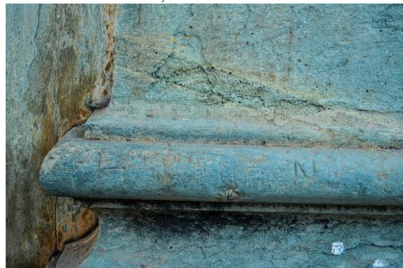
FIGURA 175 - Vandalismo na cantaria - Passo, Tiradentes/MG
