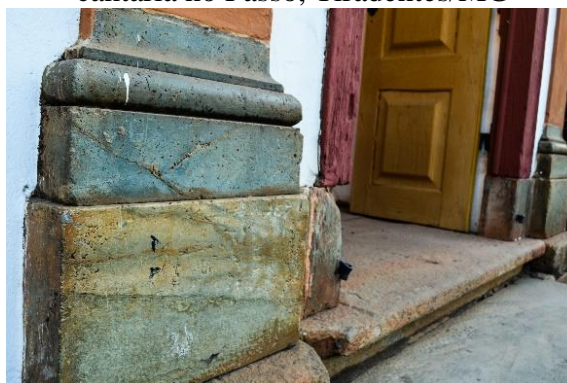
FIGURA 173 - Manchas de umidade na cantaria no Passo, Tiradentes/MG
