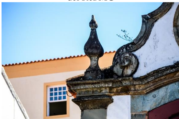
FIGURA 158 - Presença de vegetação no coroamento - Passo Rua da Prata, São João del Rei/MG
