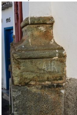
FIGURA 174 - Vandalismo na cantaria - Passo do Carmo, São João del Rei/MG
