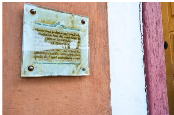
FIGURA 177 - Presença de sinalização danificada - Passo de Tiradentes/MG
