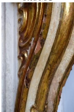
FIGURA 196 - Presença do ataque de insetos xilófagos no Passo das Mercês, São João del Rei/MG
