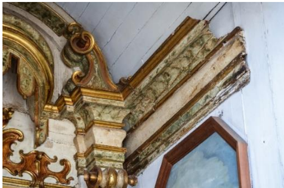
FIGURA 194 - Perda de partes - cimalha lateral direita no Passo das Mercês, São João del Rei/MG
