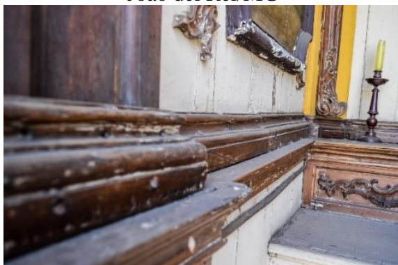
FIGURA 204 - Presença de sujidades generalizadas - Passo Largo do Rosário, São João del Rei/MG
