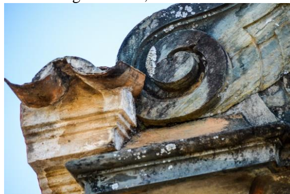
FIGURA 151 - Detalhes da presença de fungos, bactérias e manchas no coroamento - Passo Largo da Cruz, São João del Rei/MG
