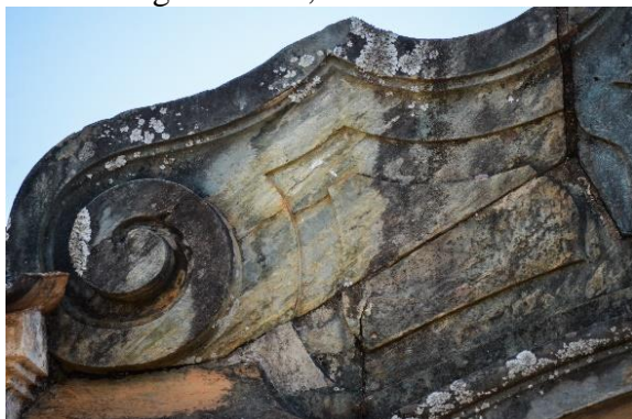
FIGURA 150 - Detalhes da presença de fungos, bactérias e manchas no coroamento - Passo Largo da Cruz, São João del Rei/MG
