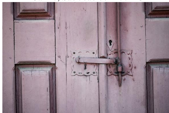
FIGURA 163 - Presença de fissuras e esmaecimento da pintura - Passo Largo do Carmo, São João del Rei/MG
