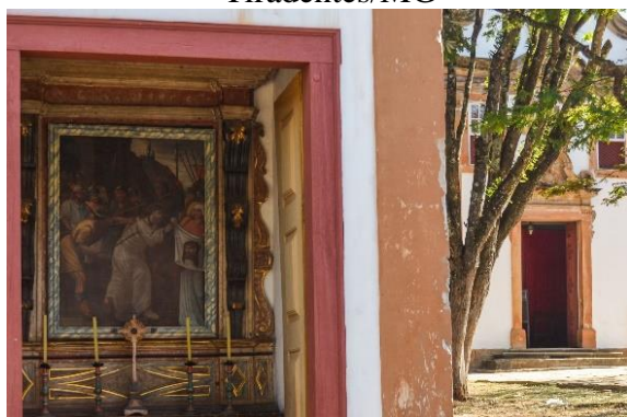
FIGURA 178 - Presença de abrasões perdas no suporte causadas pelas colisões de veículos - Passo Largo do Rosário, Tiradentes/MG
