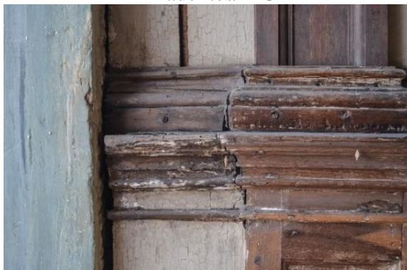
FIGURA 202 - Deslocamentos de blocos e perda de calafetações - Passo Largo da Cruz, Tiradentes/MG
