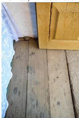
FIGURA 208 - Manchas e perda de calafetação piso em tabuado – Passo Largo das Forras, Tiradentes/MG.
