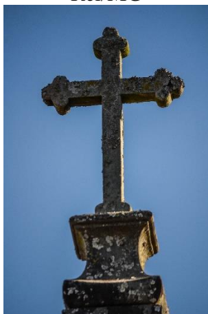
FIGURA 152 - Detalhes da presença de fungos, bactérias, manchas e vegetação na Cruz - Passo Largo da Cruz, São João del Rei/MG
