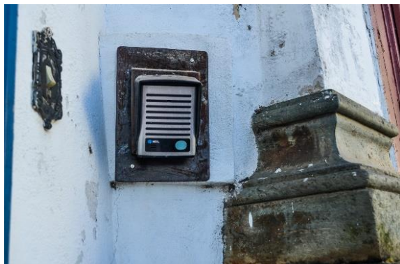
FIGURA 176 - Interfone instalado de forma irregular - Passo do Carmo, São João del Rei/MG
