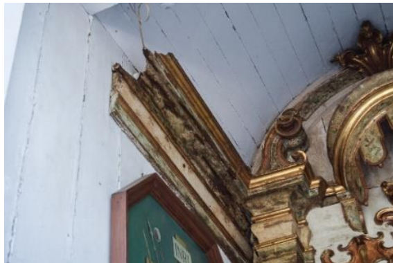
FIGURA 195 - Perda de partes - cimalha lateral esquerda no Passo das Mercês, São João del Rei/MG
