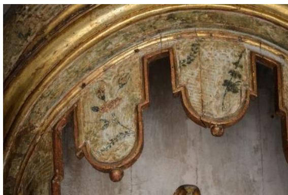
FIGURA 197 - Desgaste da pintura no Passo das Mercês, São João del Rei/MG
