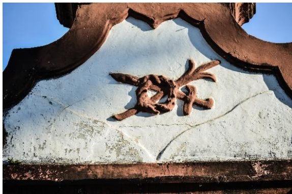
FIGURA 156 - Presença de fissuras no coroamento - Passo Largo das Forras, Tiradentes/MG
