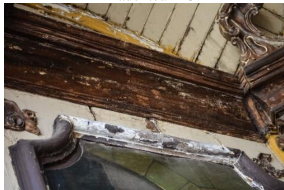
FIGURA 203 - Danos causados por infiltração no forro - Passo Largo da Cruz, Tiradentes/MG
