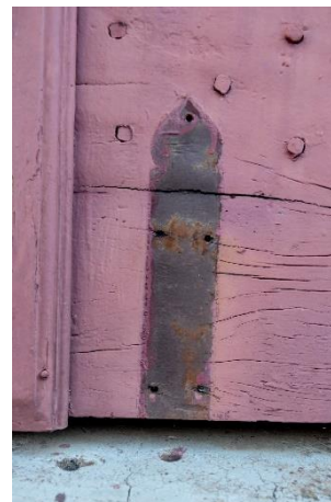
FIGURA 161 - Perda do elemento de serralheria da porta - Passo Largo da Cruz, São João del Rei/MG
