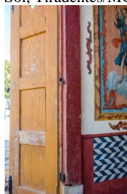
FIGURA 165 - Presença de ataque de insetos xilófagos no marco da porta - Passo Largo do Sol, Tiradentes/MG
