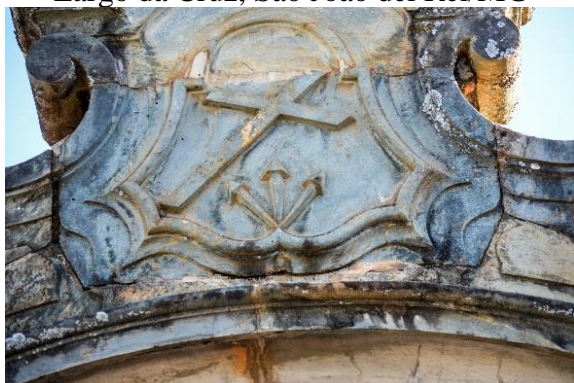
FIGURA 146 - Presença de fissuras, fungos, bactérias e manchas no coroamento - Passo Largo da Cruz, São João del Rei/MG
