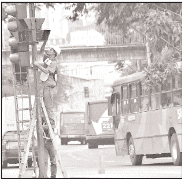
Funcionários da BHTrans reparam peça que foi alvo de ladrões. Cada equipamento, vendido por menos de R$ 50, custa ao município R$ 350
