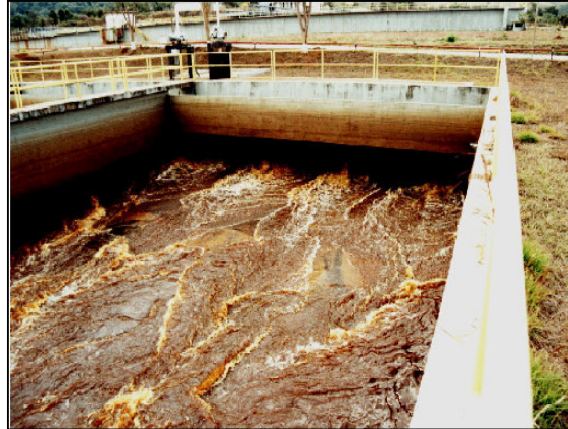
Figura 4.7 - Decantadores da UTR recebendo água proveniente da lavagem dos filtros
