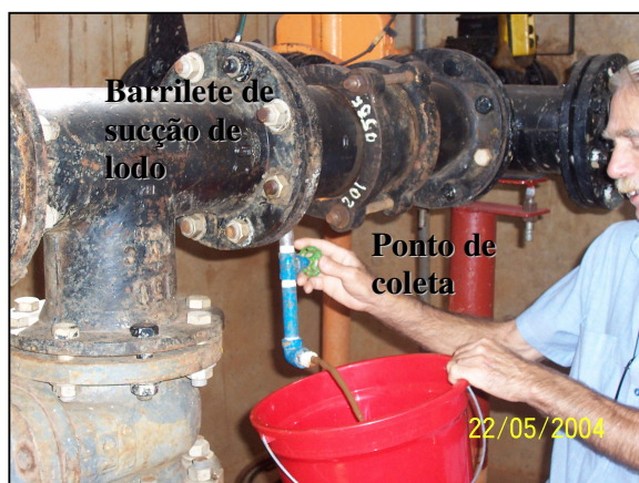
Figura 4.15 – Retirada de amostra de lodo adensado no barrilete de sucção da elevatória de lodo da UTR
