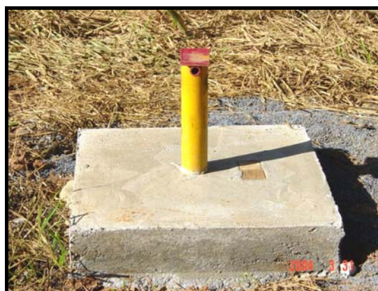
Foto 56 - Poço piezométrico simples.
