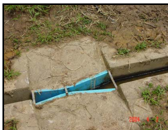
Foto 58 - Calha Parshall instalada no Cafundó.
