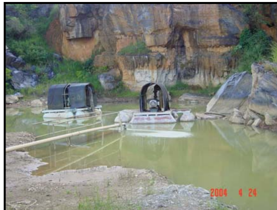
Foto 54 - Estação de bombeamento, sump .
