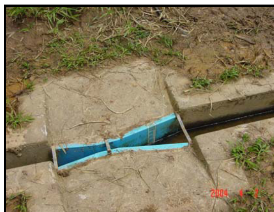
Foto 58 - Calha Parshall instalada no Cafundó.
