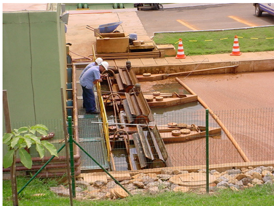
FIGURA 4.12: Sistema de remoção de lodo.
