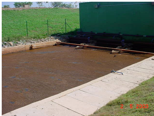
FIGURA: 4.13: Vista do lodo flotado e das calhas.
