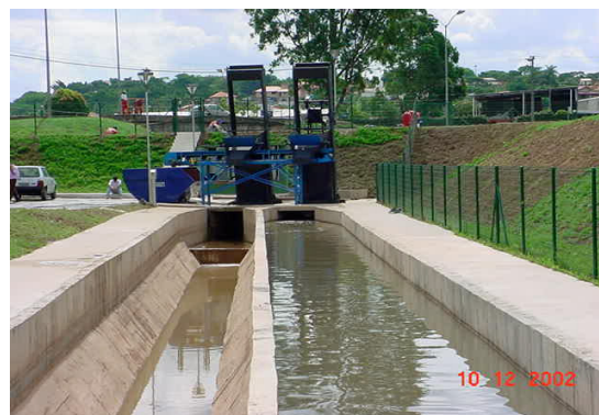
FIGURA 4.6: Caixas de areia de limpeza manual
