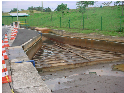
FIGURA 4.8: Tubulações de ar para mistura rápida.
