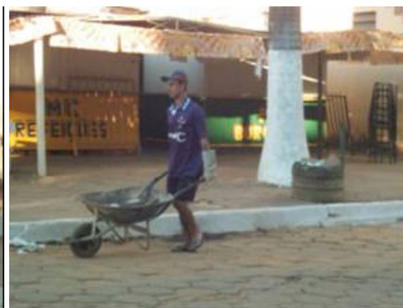
Figura 11 – Coleta do resíduo da varrição. Não se observa o uso de equipamentos de proteção adequados e uniformes.
