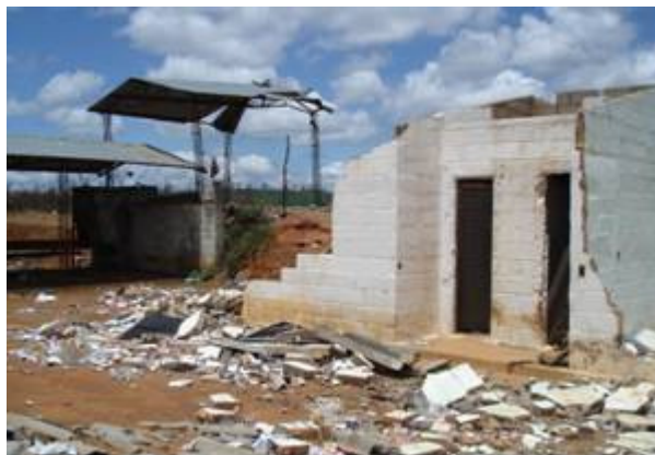
Figura 35 – Vista de uma das instalações da UTC destruída pela chuva (outubro de 2006)
