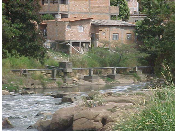
Figura 42 – Interceptor de esgotos às margens do ribeirão.
