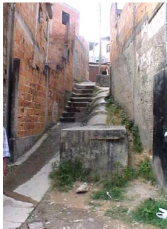
Figura 41 – Dispositivo de drenagem em via de pedestre, localizado sob moradia.
