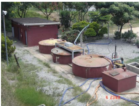
Figura 4.2 - Reservatório de lixiviado.
