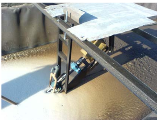
Figura 5.43 - Aerador mecânico instalado na lagoa aerada (L1) em campo.
