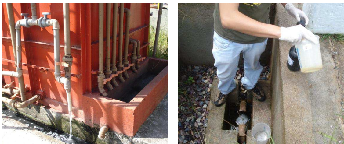
FIGURA 4.14: Ponto de coleta no reator UASB e amostragem no poço de visita do sistema de wetlands .
