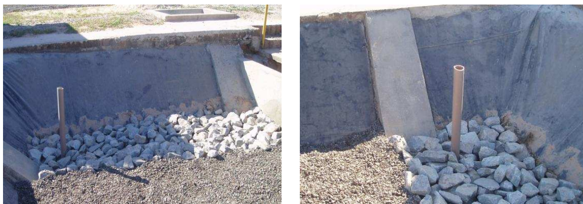
FIGURA 4.11 – Leito de drenagem com destaque para a tubulação utilizada para limpeza.
