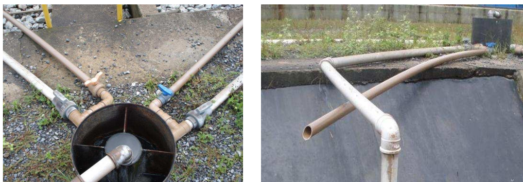
FIGURA 4.4: Tubulações para medição e controle da vazão afluyente às wetlands .
