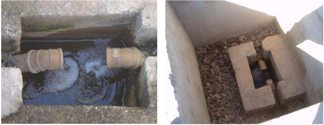
FIGURA 4.12: Poço de visita com destaque para as tubulações de coleta de amostras e medição de vazão.
