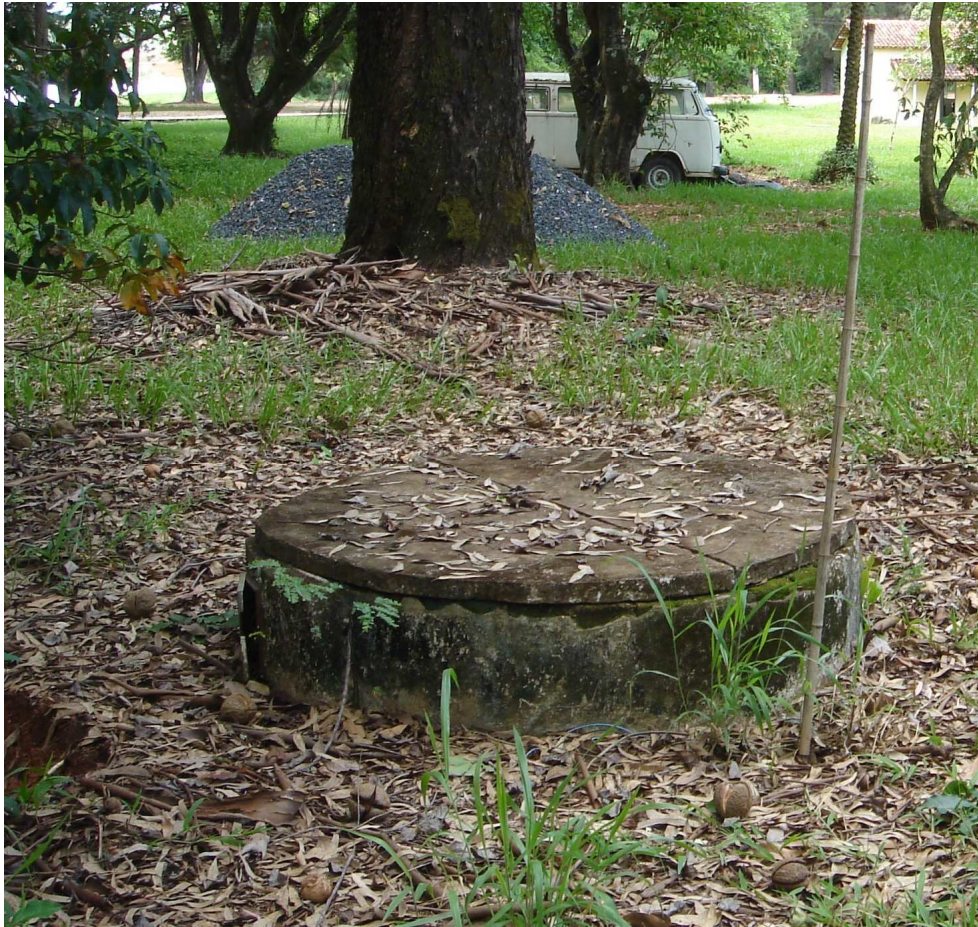
Figura 7-1 - Cisterna localizada em frente ao restaurante, utilizada para abastecer os laboratórios do prédio sede do CNPMS.
