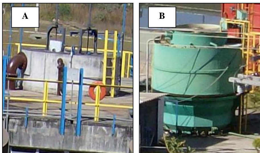
Figura 4.1 - (A) Foto da etapa de recirculação do decantador secundário do sistema de lodos ativados da ETE Arrudas COPASA (vazão média de 1,86\text{m}^3/\text{s} ) e (B) Foto do reator UASB do CePTS, com volume de 22\text{ m}^3 e vazão média afluyente de 2,88\text{ m}^3/\text{h} .
