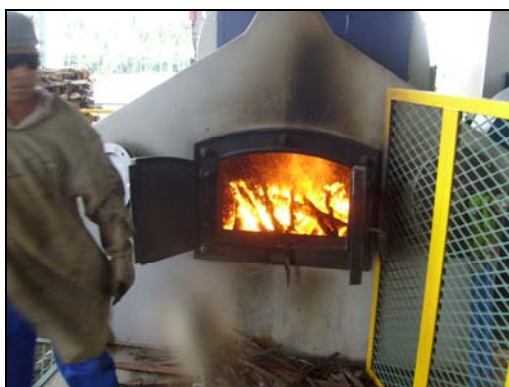
Figura 4.2: Caldeira utilizada para geração de energia térmica
