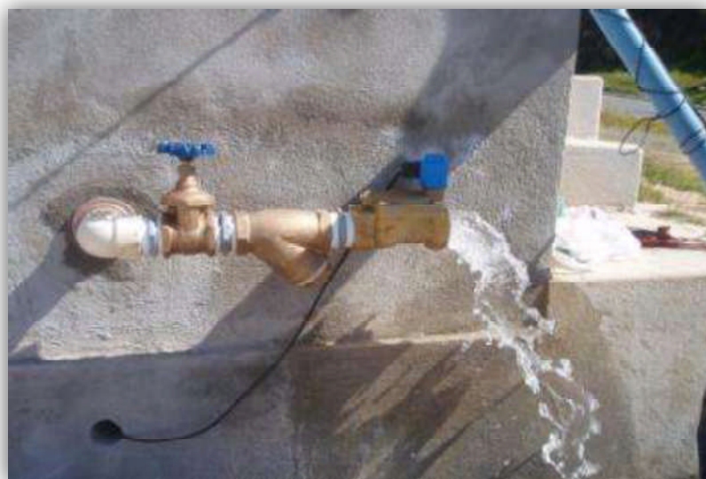
Figura 4.8 – Válvula solenóide testada no Centro de Pesquisa e Treinamento em Saneamento – CePTS
