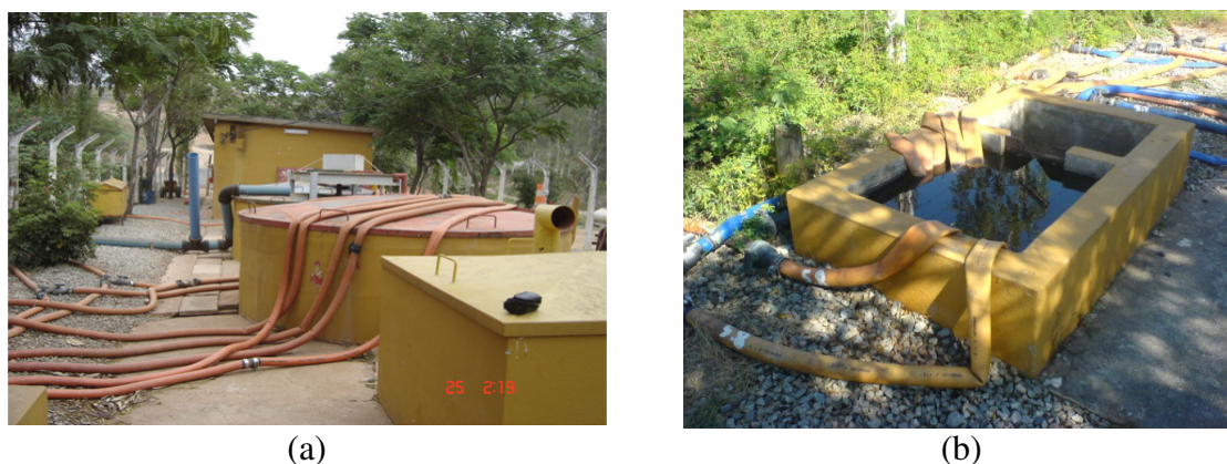
Figura 1.4.2 - (a) Estação Amarela de Tratamento de Efluentes – EATE/CTRS-BR-040 (b) Tanque de amostragem.
