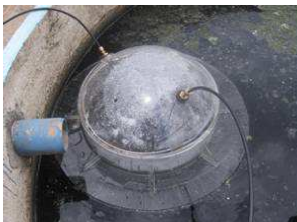
Figura 6.4 - Câmara de fluxo colocada na superfície do decantador do reator UASB.
