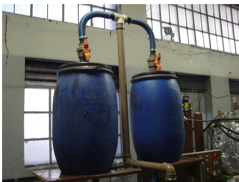
Figura 4.13 – Tanques de hidrólise – detalhe
