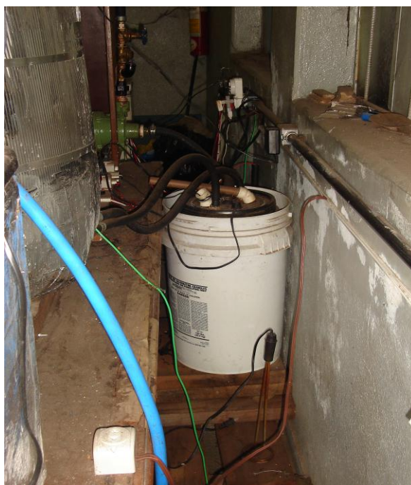
Figura 4.17 – Sistema de aquecimento de água para o reator anaeróbio
