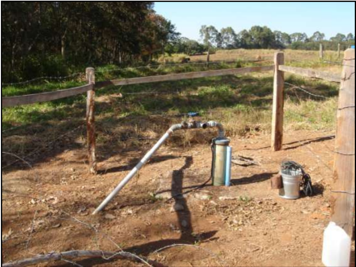
Figura F18 Poço tubular da Epamig (ponto PT-5) — sede da fazenda da Epamig
