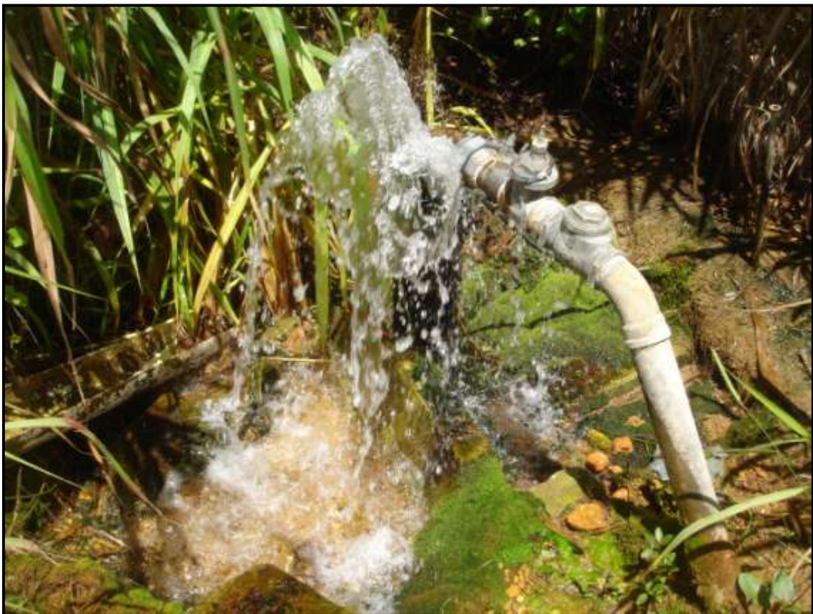
Figura F17 Poço tubular da lagoa Olhos d'Água (ponto PT-4)
