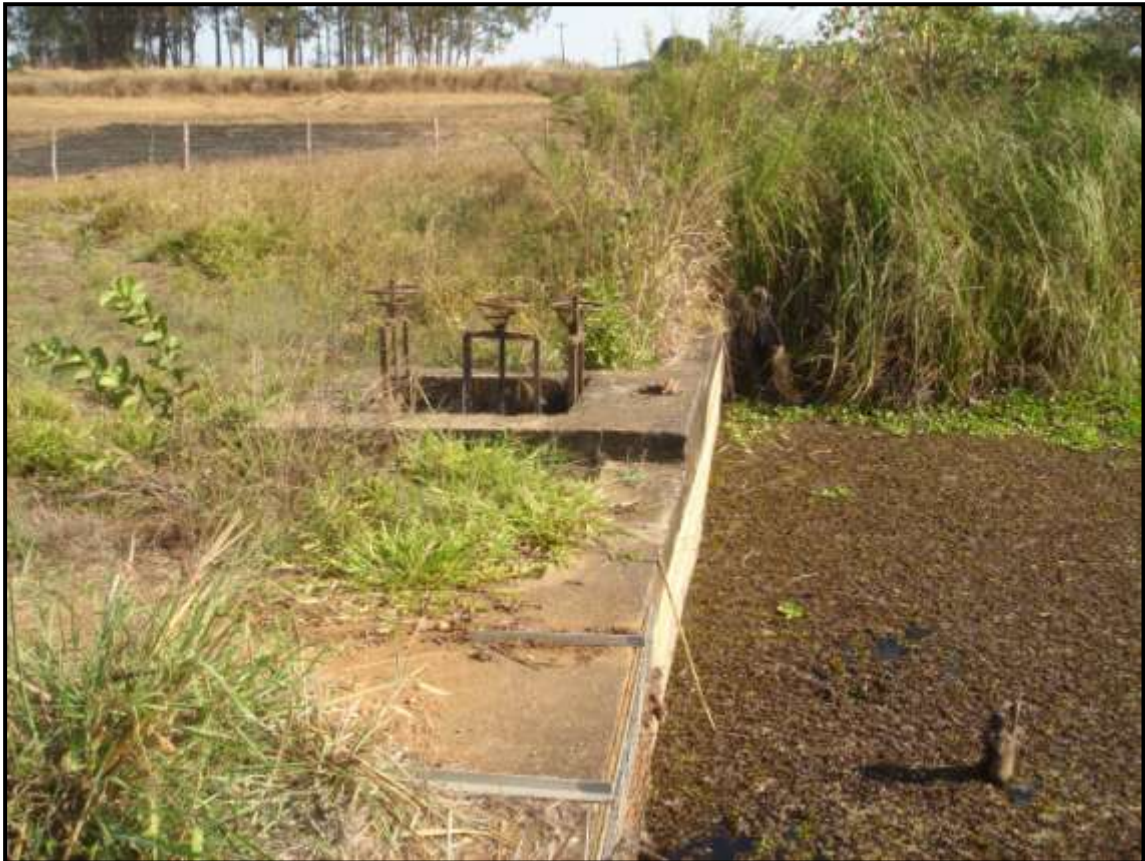
Figura F52 Vertedor da lagoa da Olhos d'Água (ponto LAG-4)
