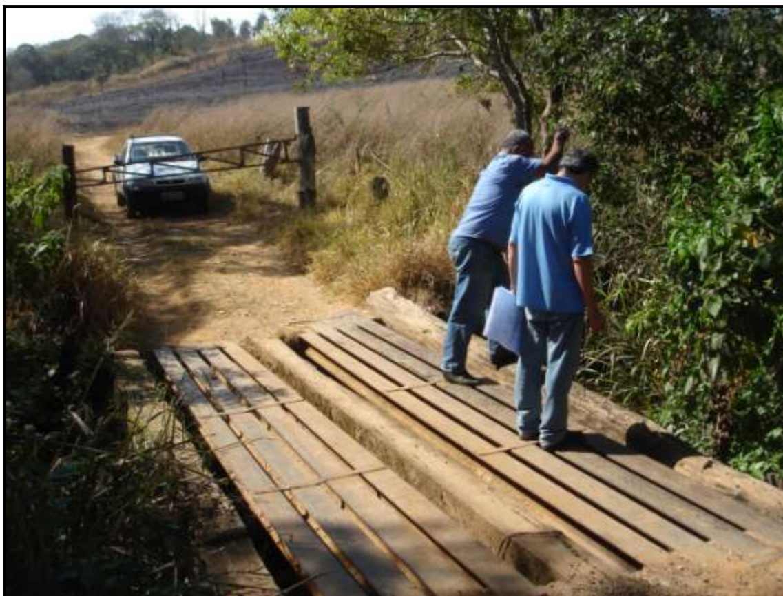
Figura F35 Ponte do córrego Marinheiro entrada da fazenda homônima (ponto MAR-1)
