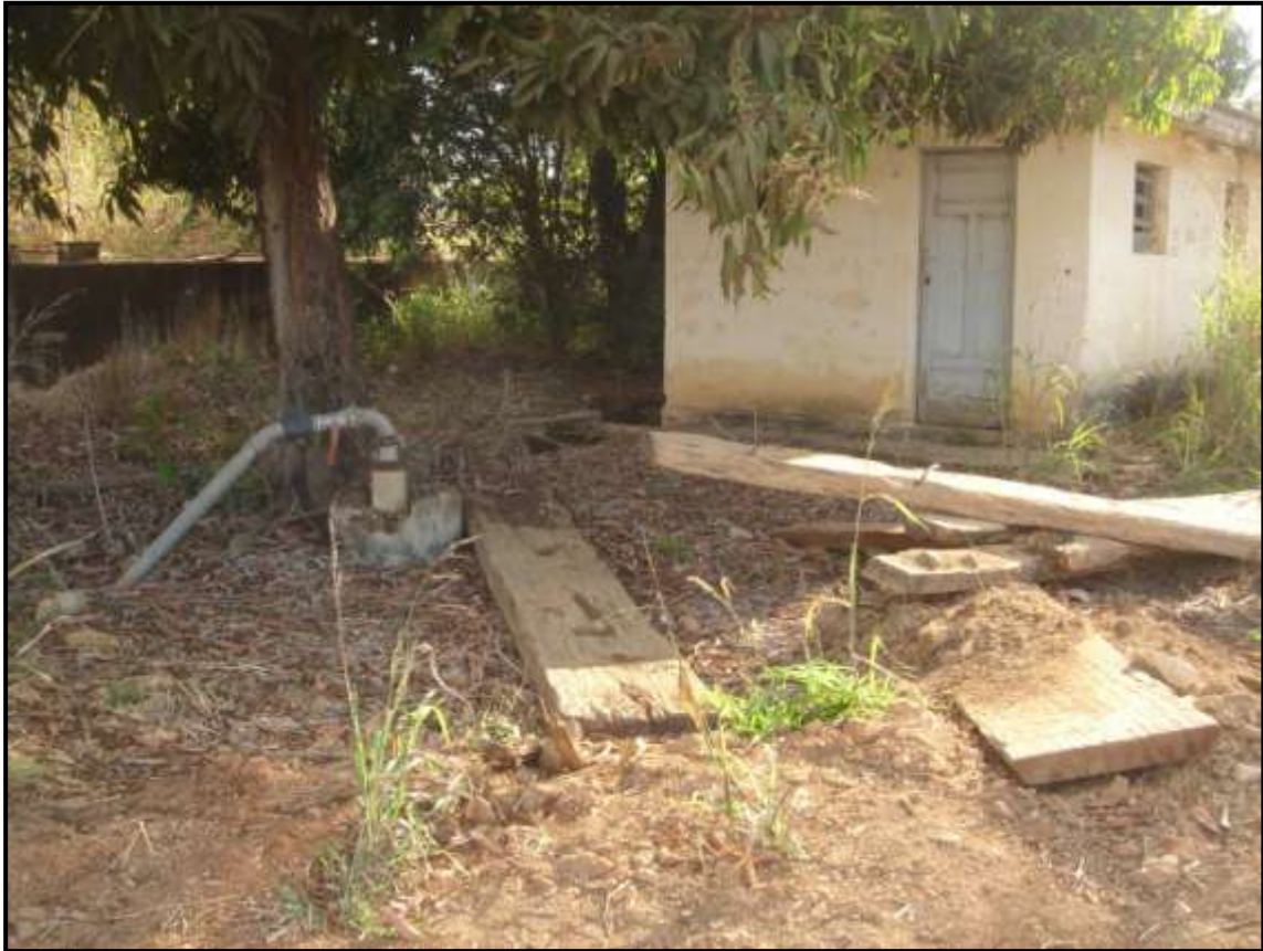
Figura F12 Poço tubular Matadouro 1 (PT 1) — ponte 2 do córrego Matadouro
