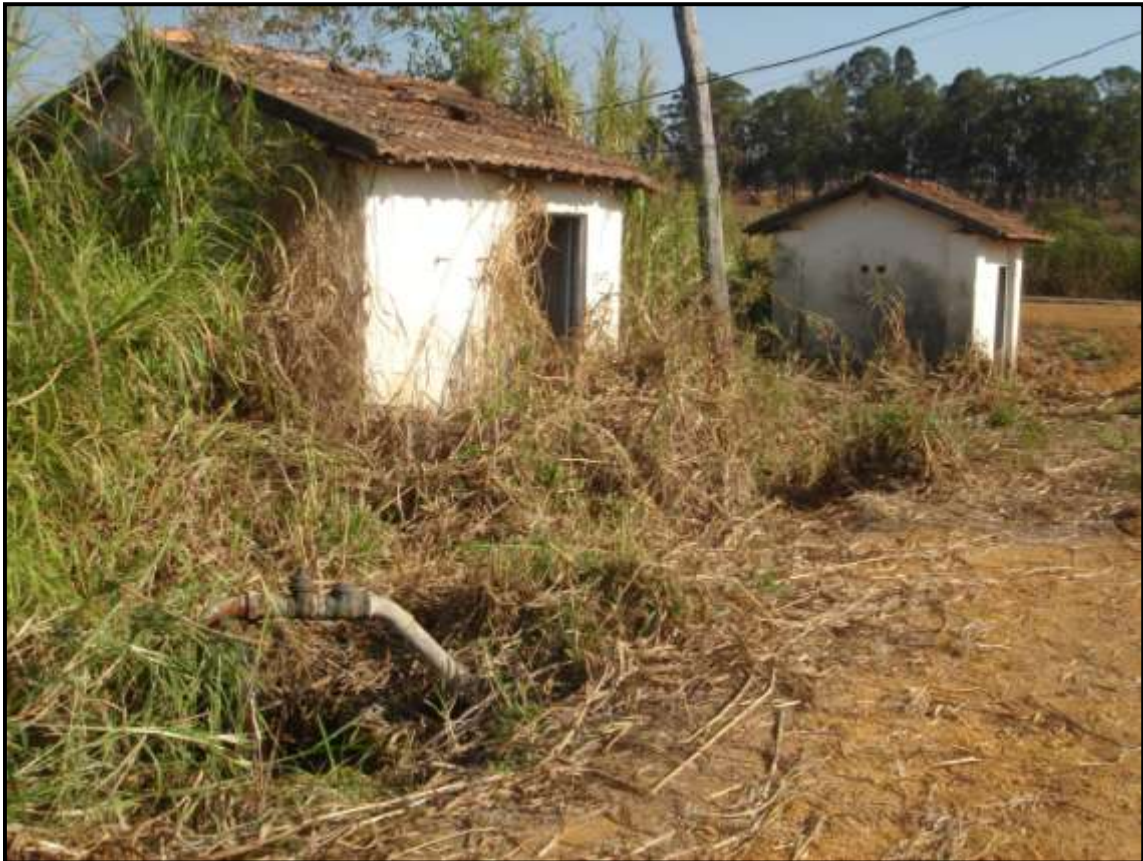
Figura F16 Local do poço tubular da lagoa Olhos d'Água (ponto PT-4)
