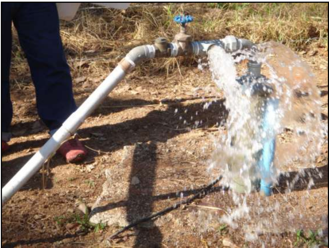
Figura F19 Poço tubular da Epamig (PT-5) – poço aberto para coleta
