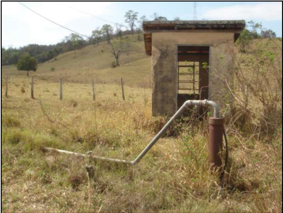
Figura F20 Poço tubular da fazenda Tavares (ponto PT-6)
