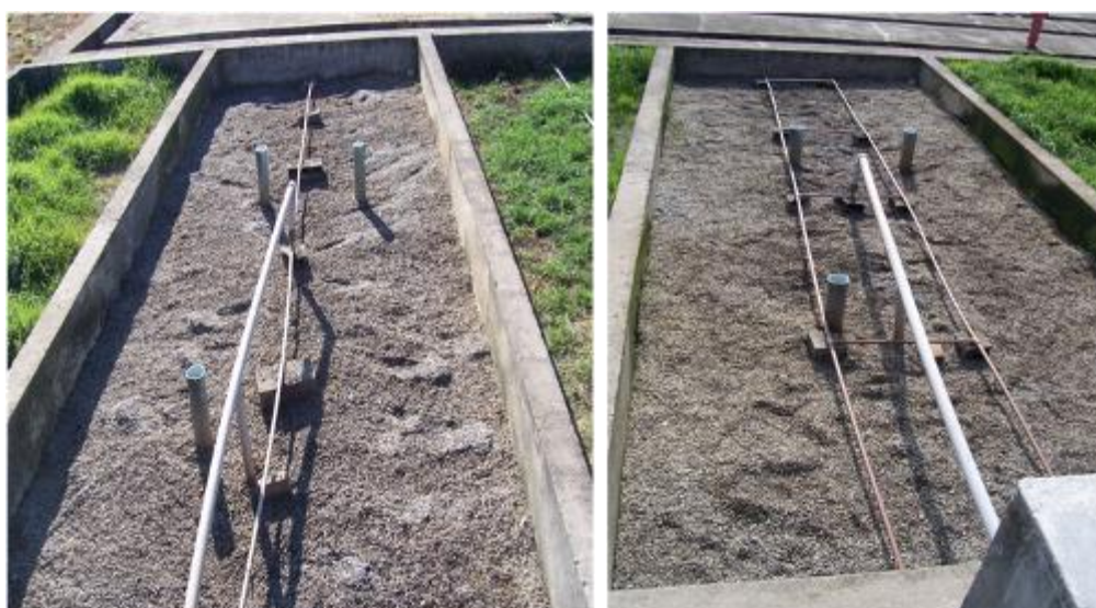
Figura 4.4: Detalhe dos sistemas de distribuição do esgoto. (a) Configuração do sistema inicial, (b) configuração do sistema instalado em outubro de 2011
