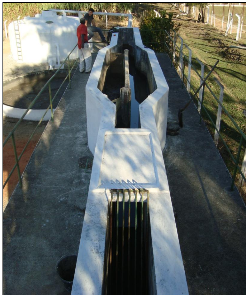
Figura 4.3 – Foto do tratamento preliminar da ETE de Bom Jesus do Amparo.
