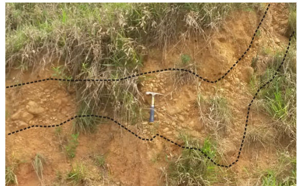
FIGURA 7.4 - Depósito deformado do ribeirão Patrimônio dos Padres localizado a jusante do anterior. Acompanha o caimento da vertente.
