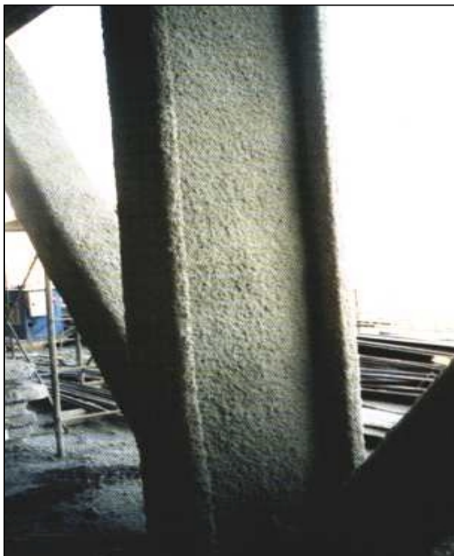
Figura 5 - Estrutura metálica protegida com uma argamassa à base de cimento e fibras minerais.
