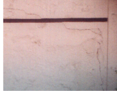
FOTO 14 FISSURA DE DESTACAMENTO
