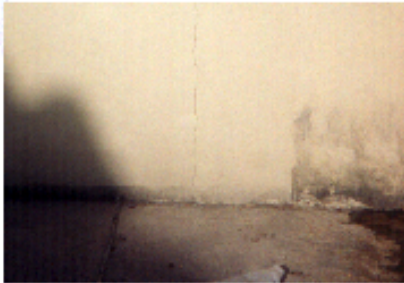
FOTO 15 TRINCA DE CONTRACÃO
