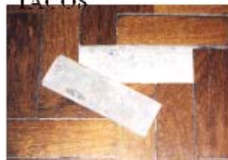
FOTO 11 DESCOLAMENTO DE TACOS
