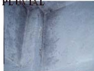
FOTO 9 INFILTRAÇÃO AGUA PLUVIAL
