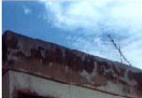
FOTO 4 DESCOLAMENTO DA PINTURA
