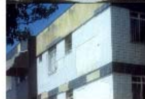
FOTO 6 DESCOLAMENTO DO REVESTIMENTO
