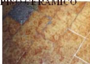
FOTO 10 DESCOLAMENTO DE PISO CERÂMICO
