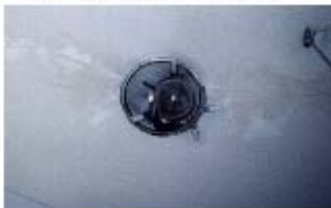
FOTO 7 TRINCA NA LAJE
