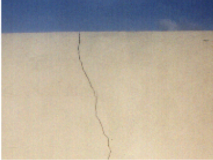
FOTO 13 FISSURA DE CONTRACÃO EM MURO
