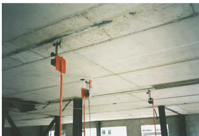
Figura 5.30- Vista dos DT's
