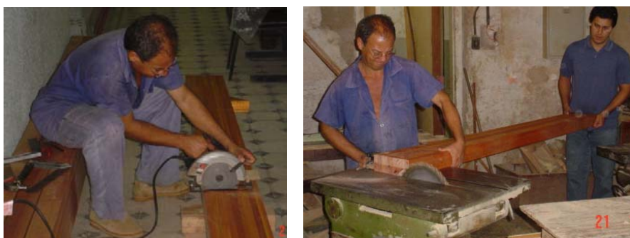
FIGURA 43 – Corte na viga
