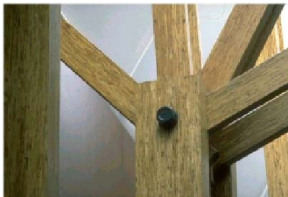
FIGURA A4 – Ligação aparentemente concentrada Fonte: AF&PA - The Wood Connection Session, 2002, p. 8.
