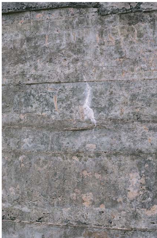
FIGURA 3.53 – Lixiviação de hidróxido de cálcio pelas fissuras da viga da cobertura
