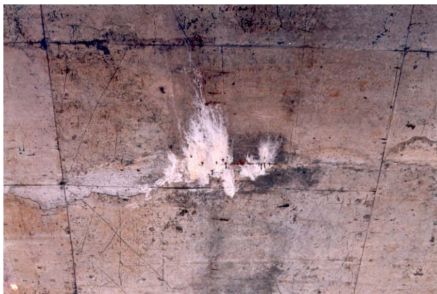
FIGURA 3.60 – Lixiviação de hidróxido de cálcio contaminada com óxido de ferro
