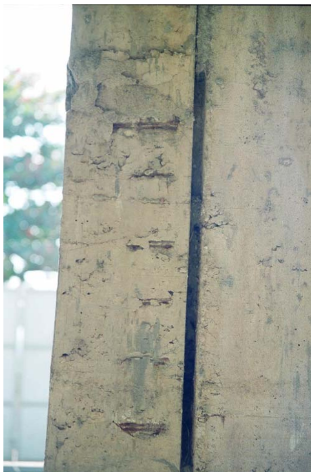
FIGURA 3.27 – Corrosão nos estribos causada pelo pequeno cobrimento e pela presença de falhas de concretagem de pequeno tamanho
