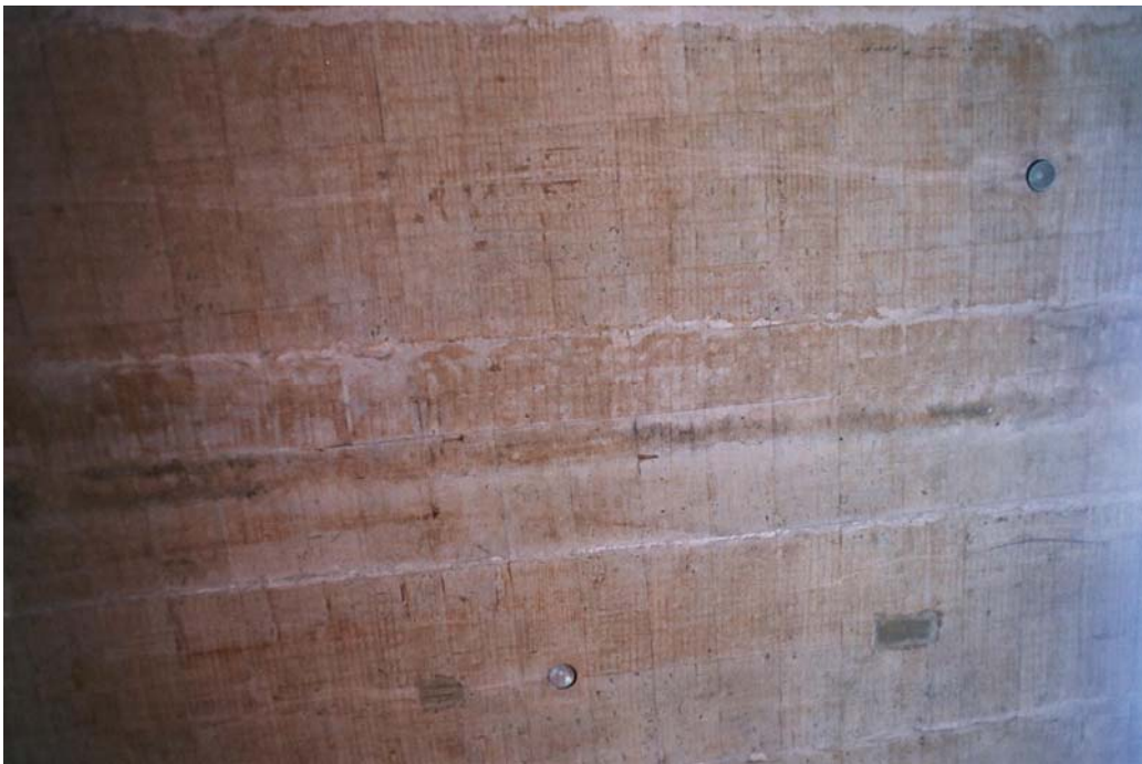
FIGURA 3.59 – Lixiviação de hidróxido de cálcio no alinhamento da variação de espessura da laje
