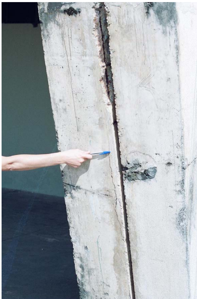
FIGURA 3.20 – Fissura causada pela corrosão da armação do pilar
