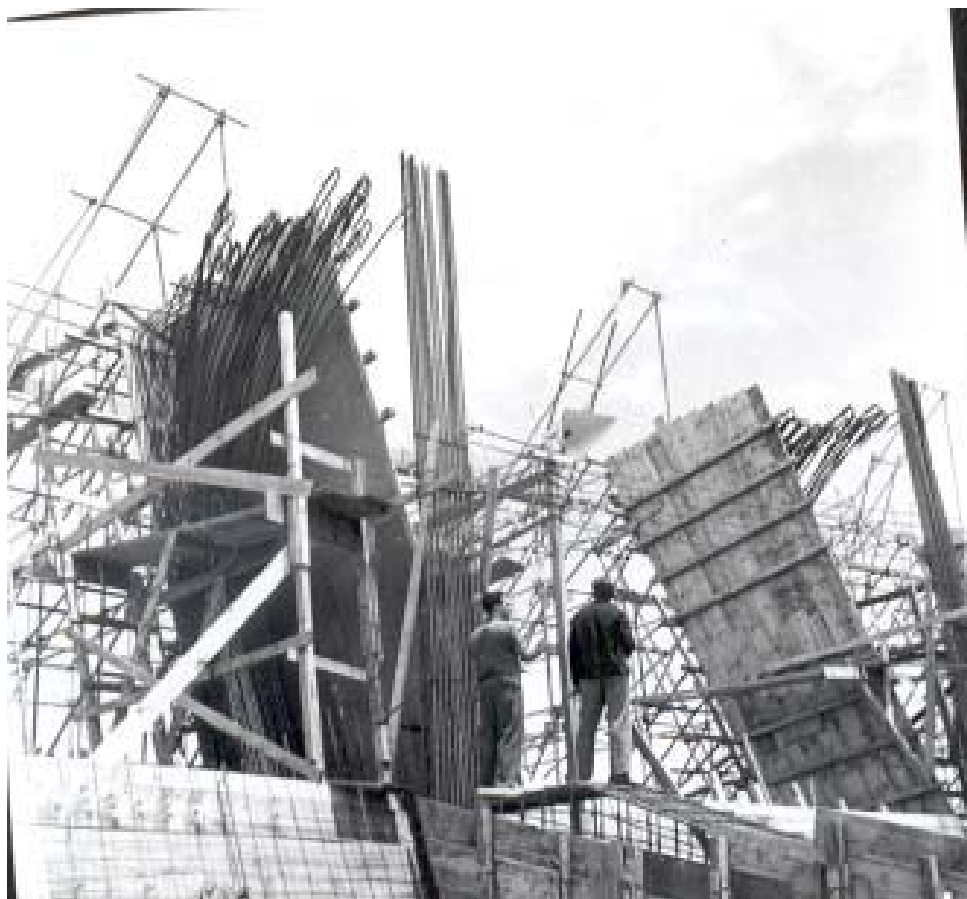
FIGURA 3.21 – Armação, ainda não concluída, da região da ligação entre o pilar externo e a viga da cobertura
