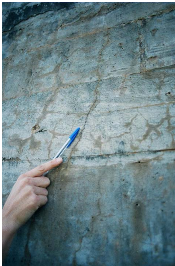
FIGURA 3.48 – Fissuras de retração hidráulica na face lateral da viga de cobertura
