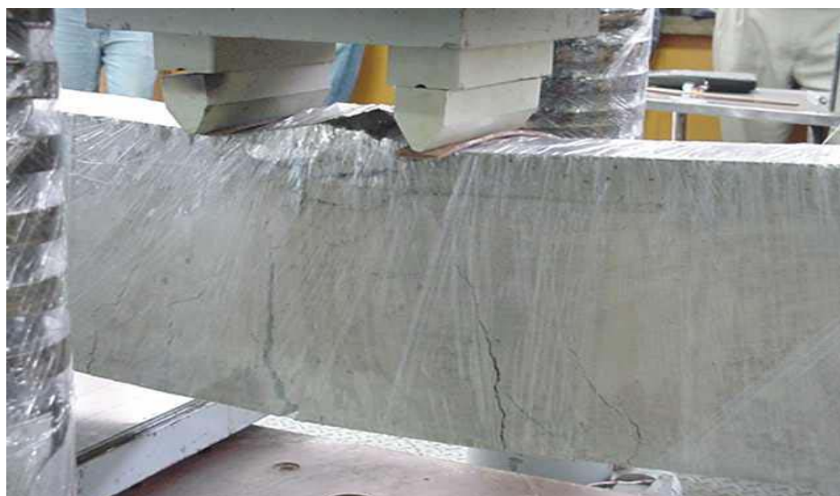
FIGURA 2.47 – Fissuração e ruptura características de esforços de compressão em viga isostática
