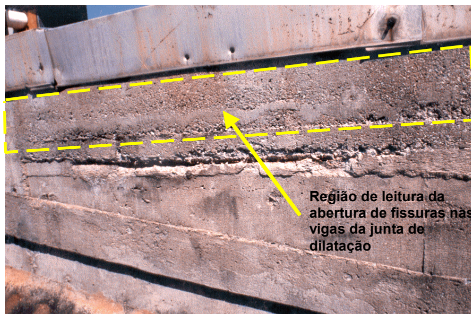
FIGURA 3.87 – Demarcação da região onde foi feita a leitura da abertura das fissuras nas vigas das junta de dilatação
