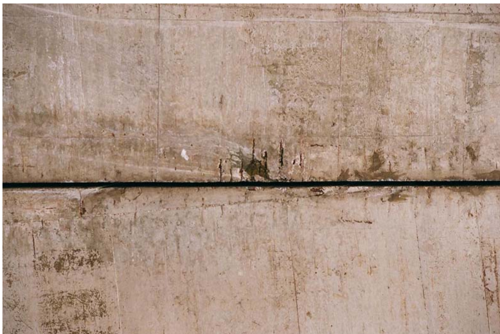
FIGURA 3.62 – Corrosão das armações na região da junta de dilatação
