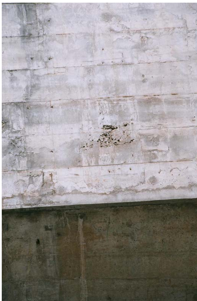
FIGURA 3.39 – Falhas de concretagem na viga-parede
