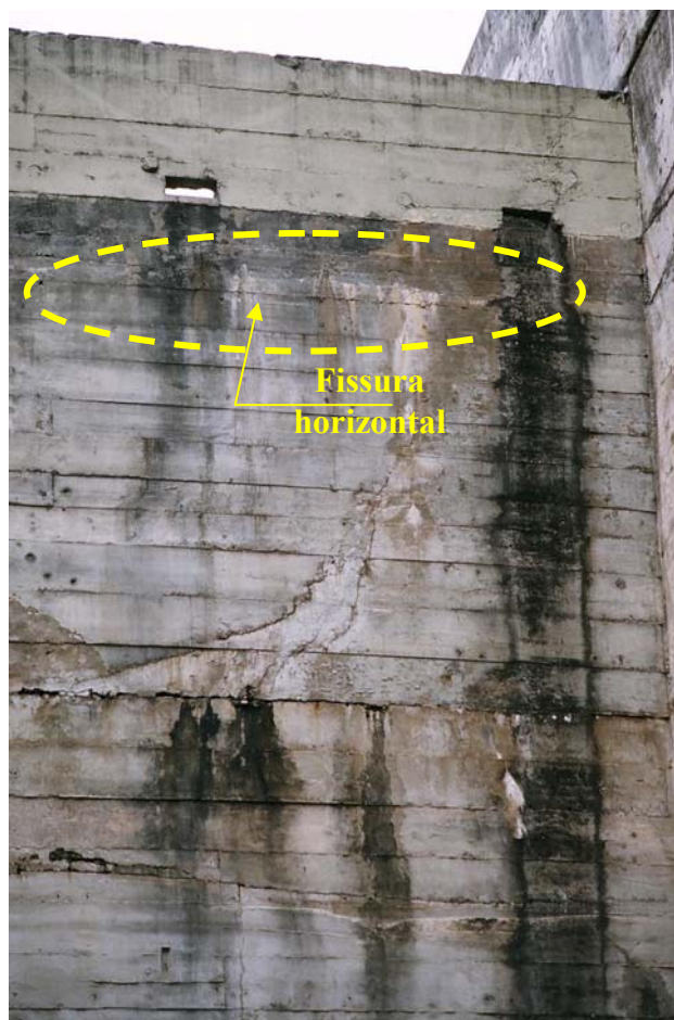
FIGURA 3.38 – Fissura horizontal na viga-parede no nível da calha da cobertura
