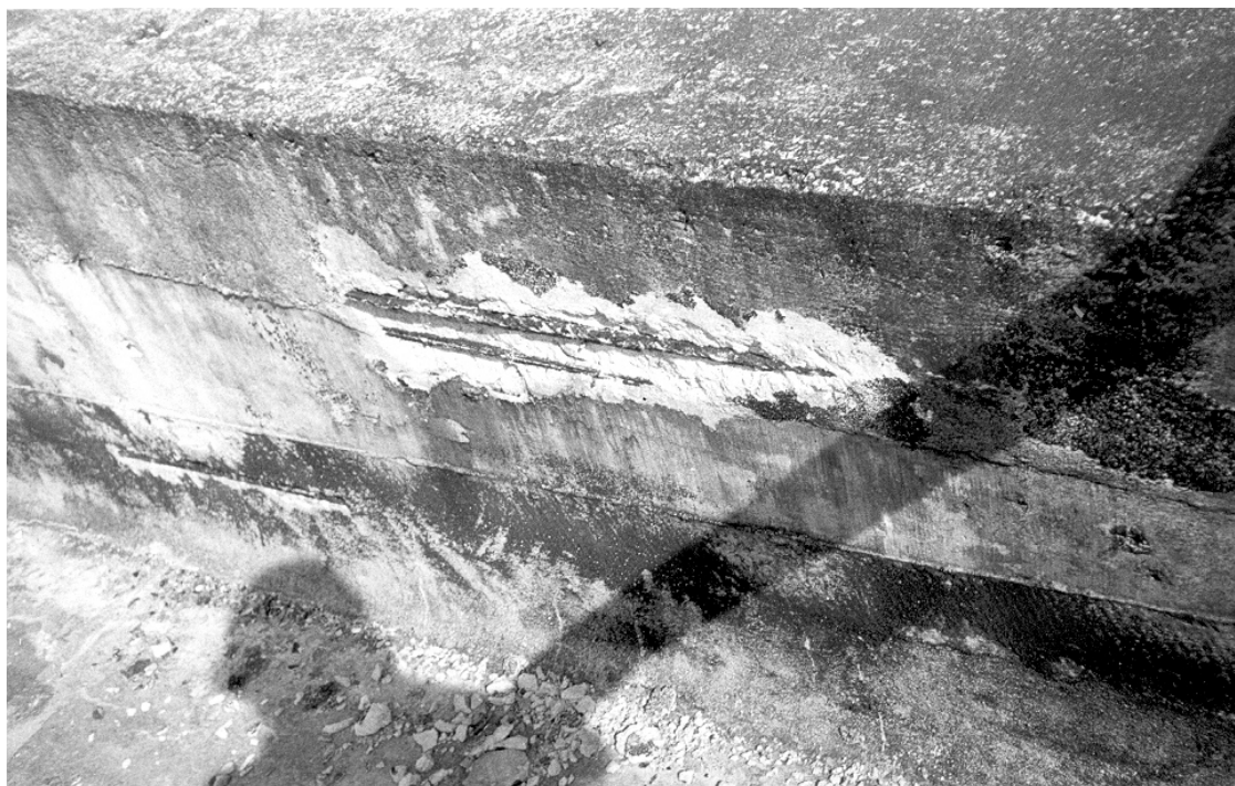
FIGURA 3.75 – Corrosão já instalada em uma das vigas da cobertura. Observa-se o pequeno revestimento da mesma, tendo sido isto a causa da corrosão
