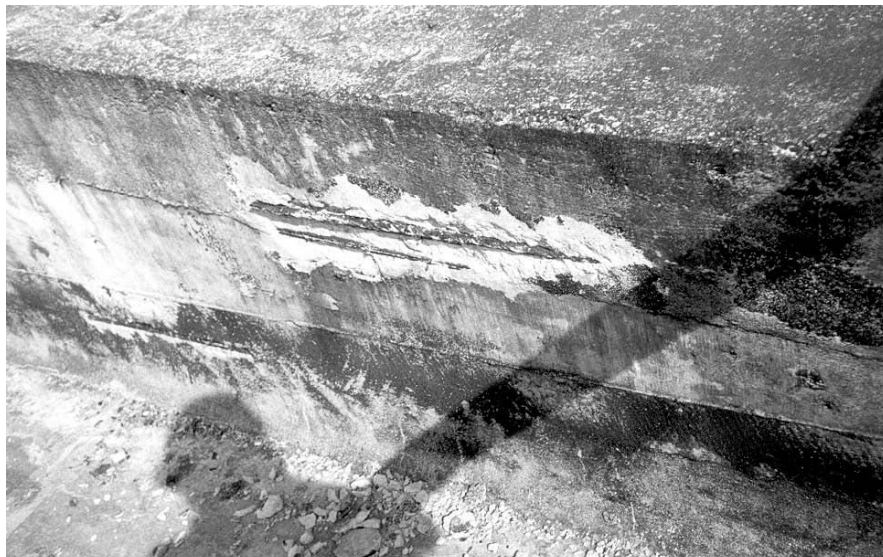
FIGURA 3.55 – Foto mostrando a recuperação da viga da cobertura que apresentava corrosão da armação destinada a combater as fissuras de retração
