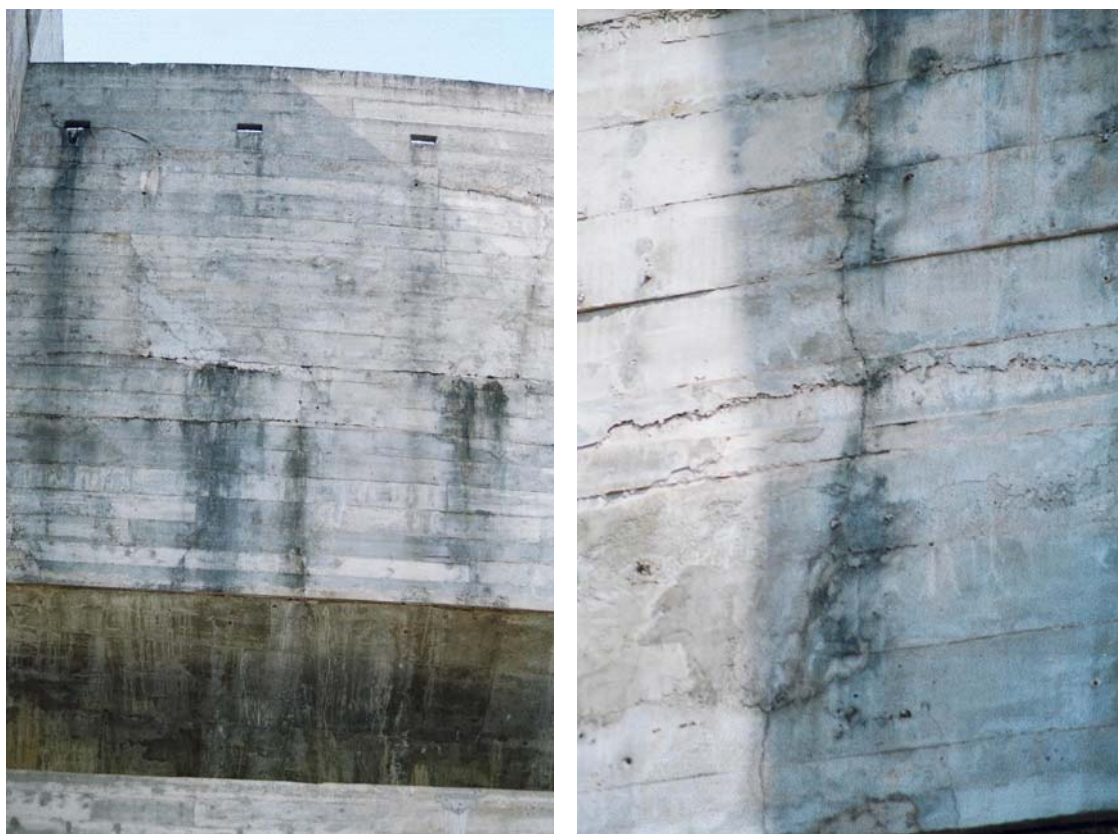
FIGURA 3.37 – Foto de uma viga-parede fissurada na região central. Ao lado é mostrado, em detalhe, outra fissura vertical central
