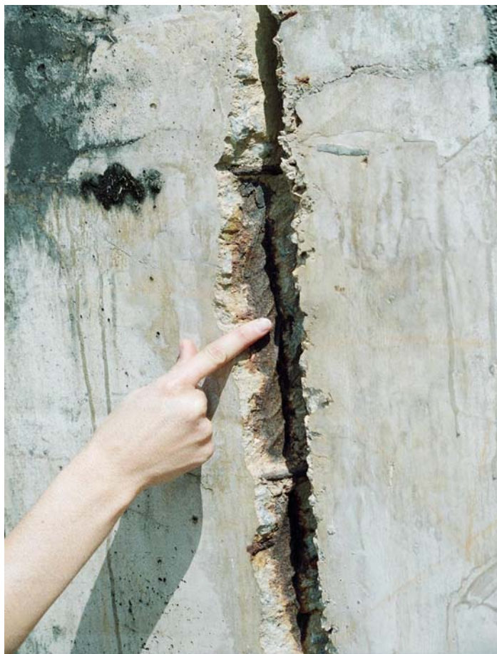
FIGURA 3.77 – Corrosão já instalada em uma armação principal e estribos do pilar externo
