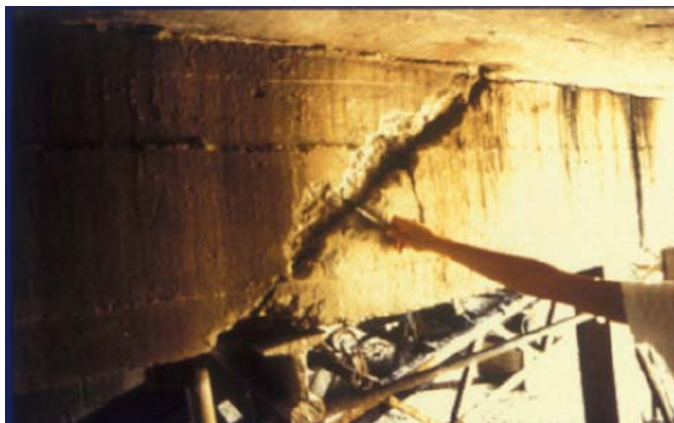
FIGURA 2.50 - Fissura em viga provocada por esforços de cisalhamento
