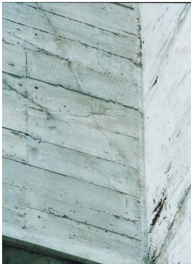
FIGURA 3.34 – Detalhe das fissuras a 45° no apoio de uma viga-parede
