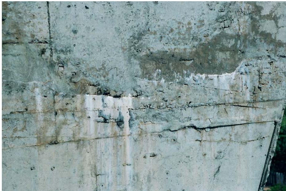
FIGURA 3.25 – Lixiviação de hidróxido de cálcio no alinhamento de uma fissura horizontal
