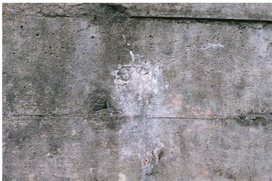
FIGURA 3.54 – Lixiviação de hidróxido de cálcio pelos poros do concreto
