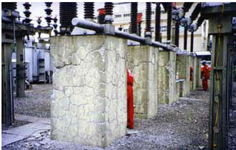
FIGURA 2.34 - Fissuras causadas pela reação expansiva com álcali-agregado
