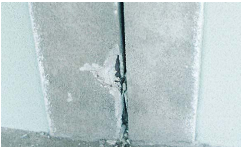
FIGURA 3.78 – Corrosão da armação de pilar interno
