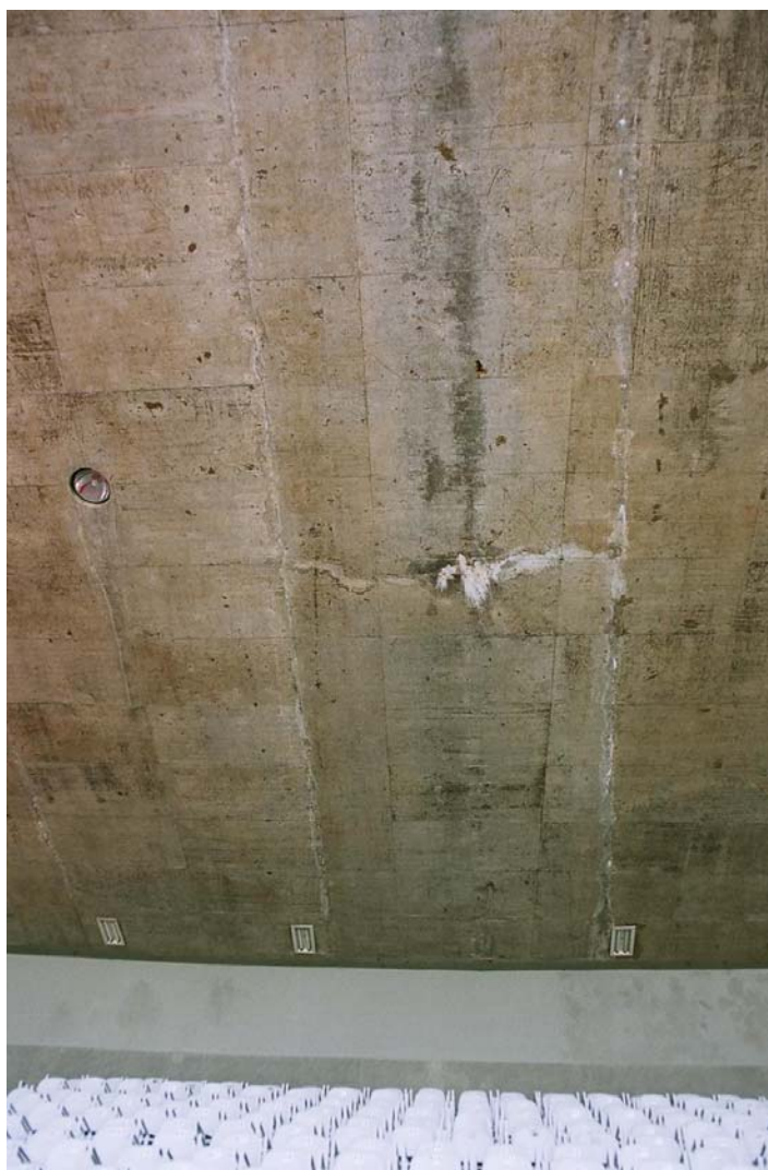
FIGURA 3.58 – Lixiviação de hidróxido de cálcio nas juntas de concretagem das lajes da cobertura
