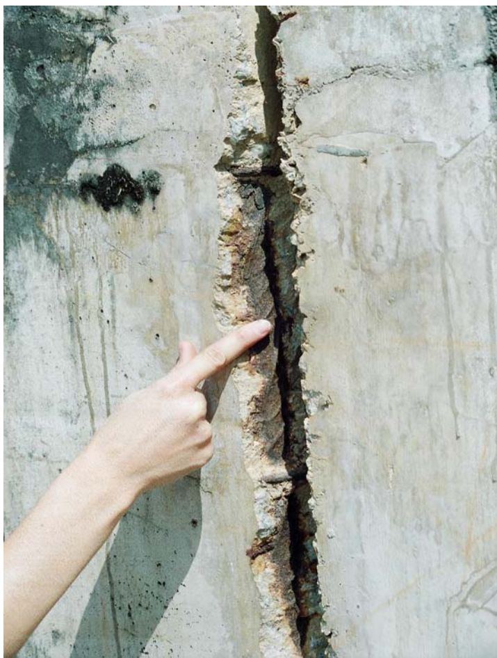
FIGURA 3.26 - Corrosão já instalada em uma armação principal e estribos do pilar
