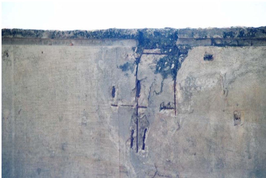
FIGURA 3.63 – Corrosão das armações devido ao pequeno cobrimento na região da pingadeira
