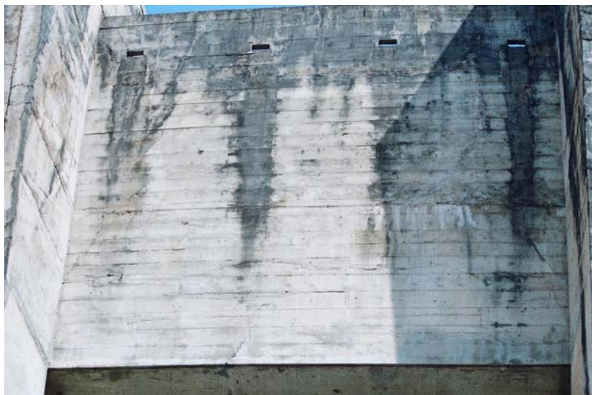
FIGURA 3.33 – Fissuras com inclinação próxima a 45° nos apoios da viga-parede
