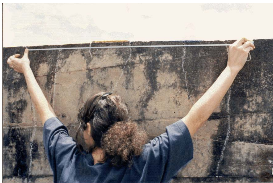
FIGURA 3.89 – Fotografia mostrando as fissuras existentes em um trecho de um metro. Para melhor visualização, as fissuras foram realçadas com giz
