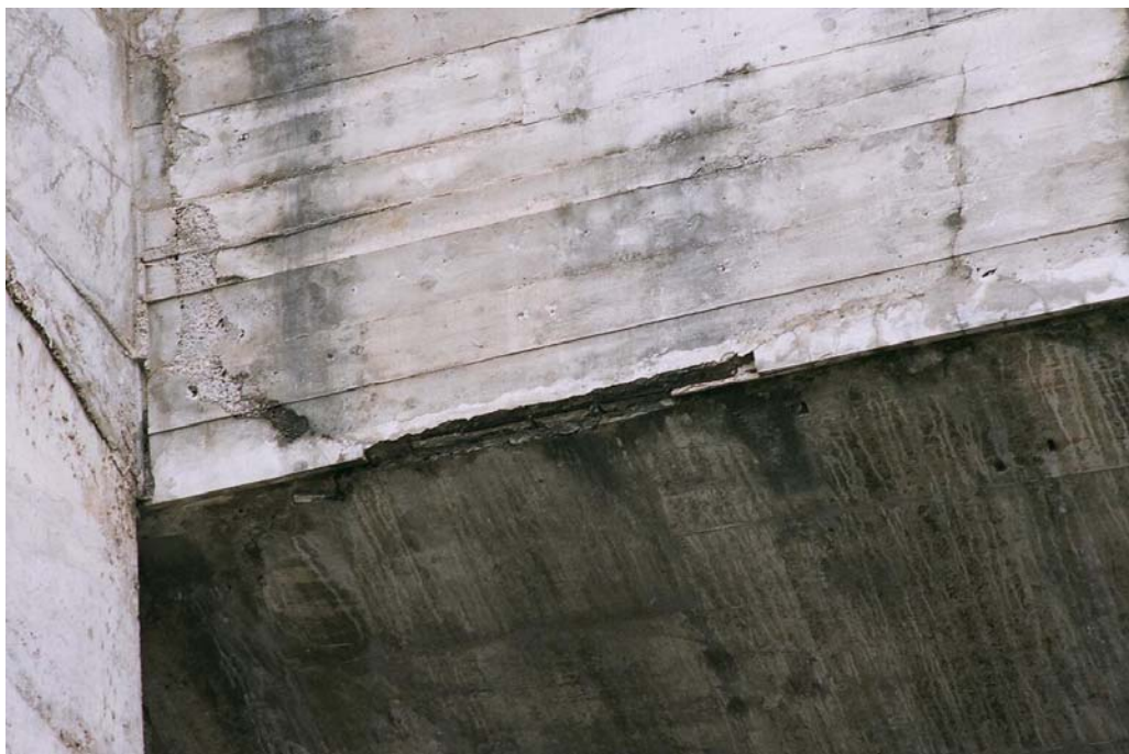
FIGURA 3.40 – Corrosão nas armações positivas da viga-parede
