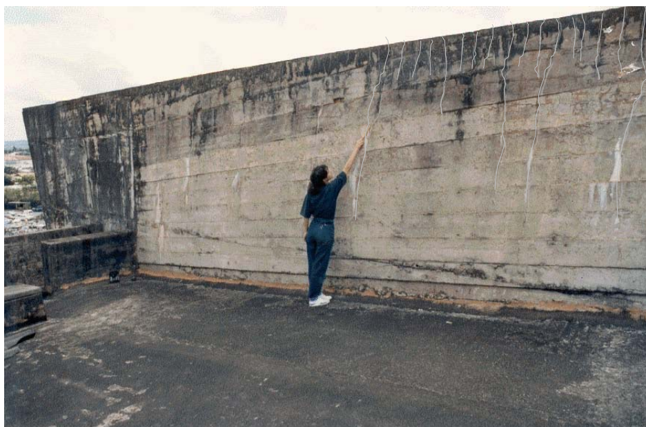
FIGURA 3.88 – Fotografia de uma viga da cobertura analisada. Algumas fissuras foram realçadas com giz branco
