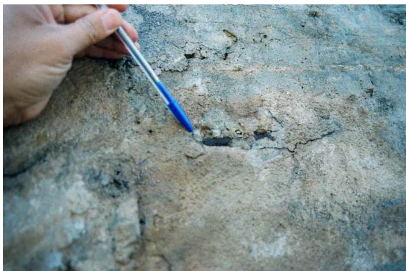
FIGURA 3.28 – Corrosão nas armações de um pilar externo
