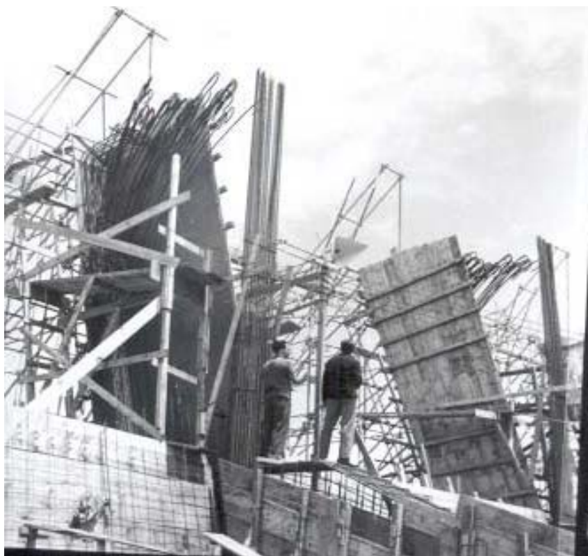
FIGURA 2.101 – Fotografia tirada durante a montagem da armação dos pilares externos, no nível acima da viga da arquibancada
