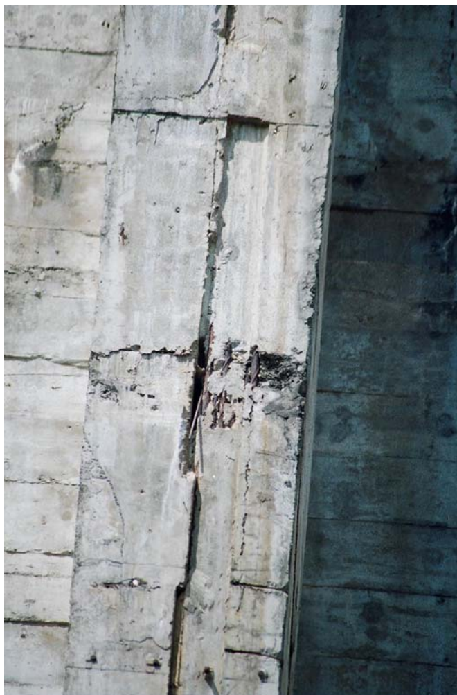
FIGURA 3.24 – Falha de concretagem, expondo as armações do pilar no nível da viga-parede
