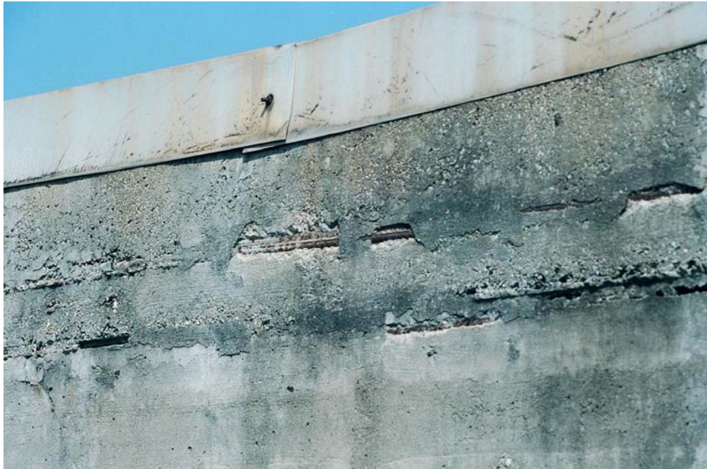
FIGURA 3.56 – Foto tirada recentemente, registrando as armaduras aparentes
