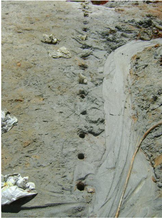
Figura 8 Filão de minas com a massa expansiva inserida aguardando o tempo médio de 24 horas para a separação e o tombamento da prancha. Em alguns casos o tempo pode variar, também pode ser necessária a utilização de cunhas e do martelo pneumático para concluir a separação. Feita a separação a retro-escavadeira realiza o tombamento da prancha cortada (Foto Janeiro de 2011);
