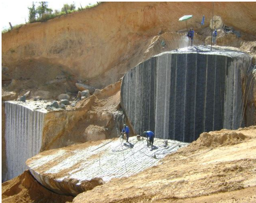
Figura 106 Corpo de rocha solto do maciço rochoso em processo de divisão. Na parte superior os operários realizam furos preparando a separação de pranchas. No chão, encontram-se trabalhadores realizando furos para a divisão de blocos em uma prancha.
