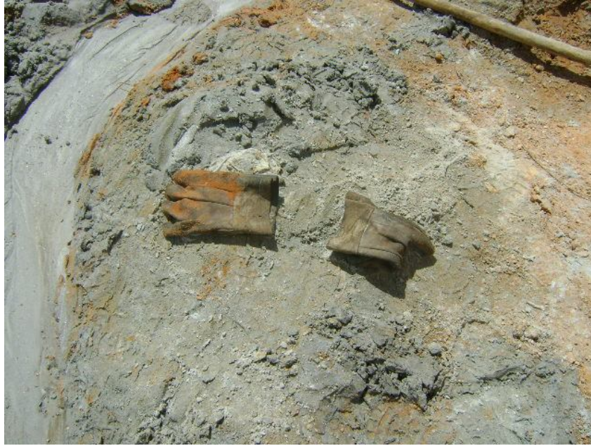
Figura 120 Pó de sílica proveniente de perfuração de rocha. Na imagem podemos perceber que com a ação do sol e calor o pó está perdendo a umidade, ficando em estado de partículas solta. Depois de seco, o pó pode ser suspenso no ar pelo vento, pela movimentação de blocos que levantam poeira, etc
