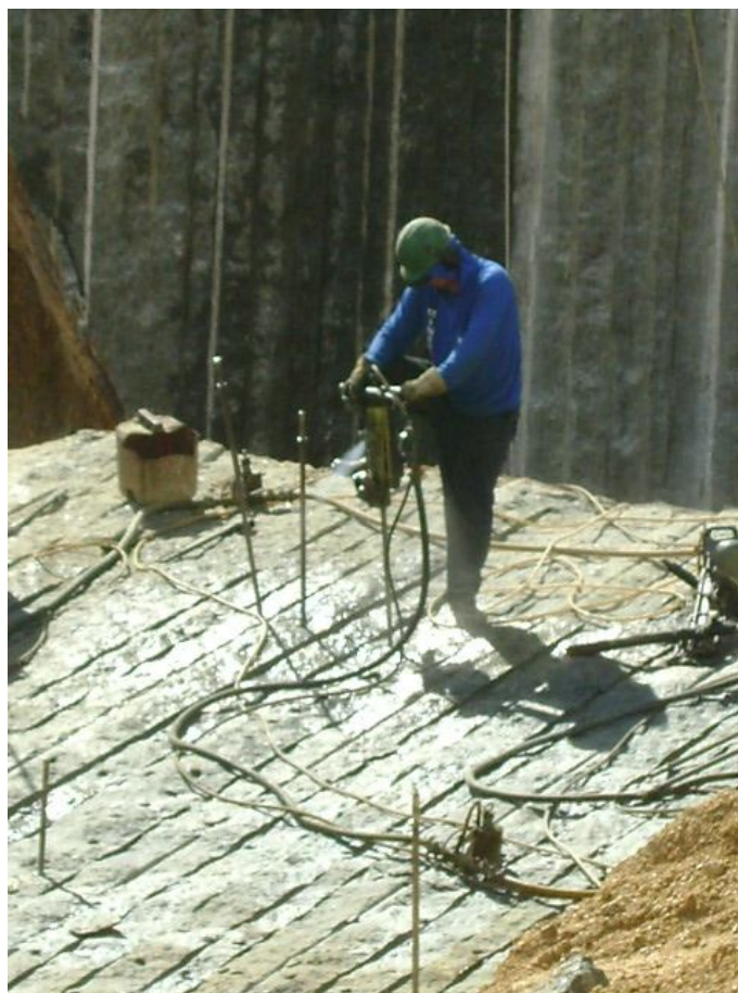
Figura 18 Martelo Pneumático em funcionamento sobre a prancha realizando os furos para corte dos blocos.
