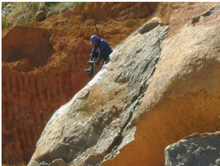
Figura 4 Trabalhador furando a rocha em local alto e íngreme, sem se utilizar da grade de proteção.
