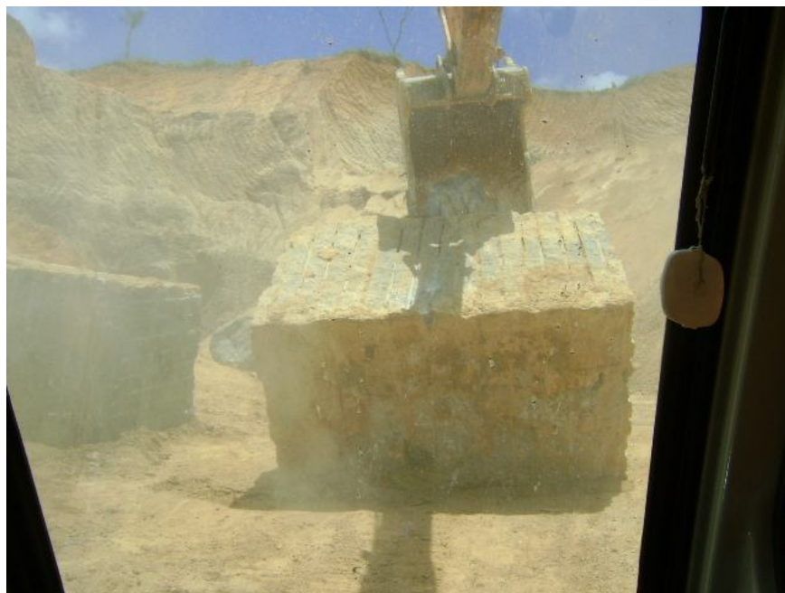
Figura 123 Na imagem da movimentação do bloco é possível ver a quantidade de poeira suspensa no ar.
