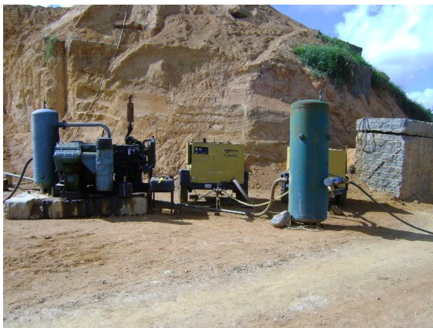
Figura 114 Conjuntos de compressores que abastecem a pedreira de energia para a realização dos trabalhos.
