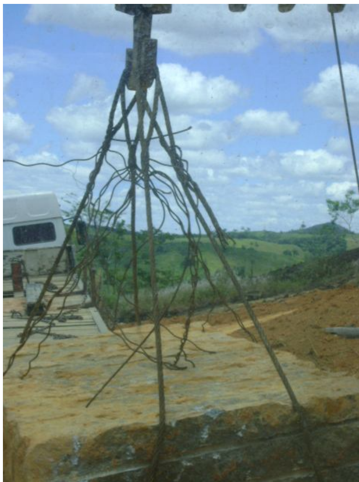
Figura 46 Cabos entrelaçados sustentando o bloco enquanto a carreta manobra da maneira correta para que o bloco possa ser acomodado na carroceria, para realização do carreto;
