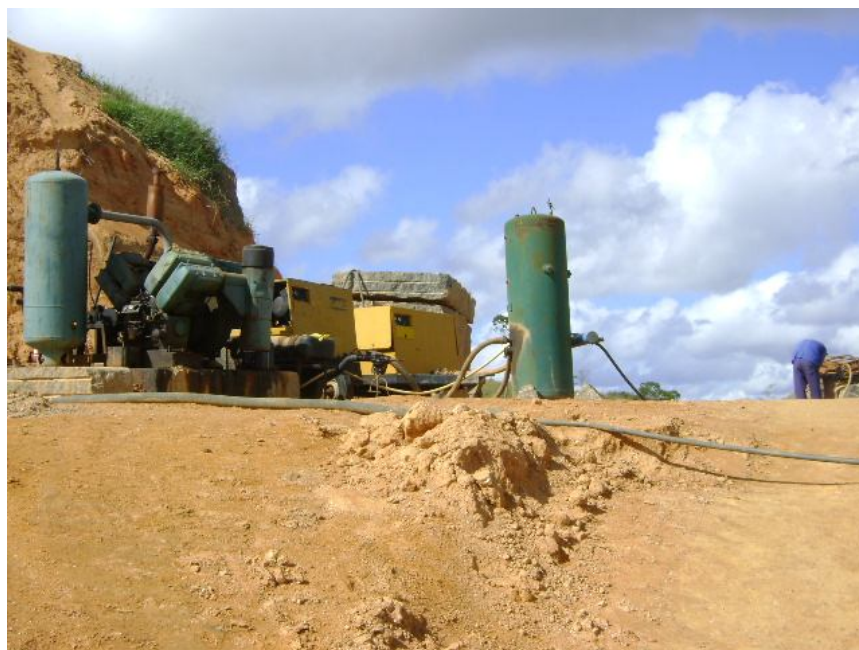
Figura 115 Conjuntos de compressores que abastecem a pedreira de energia.
