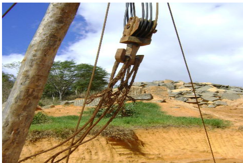
Figura 59 No pau-de-carga, verifica-se que os cabos de aço estão entrançados 37 .
