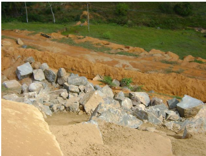
Figura 103 Rejeitos jogados em barranco que se localiza acima de vias de transito de veículos e pessoas. (Foto tirada em julho de 2010).
