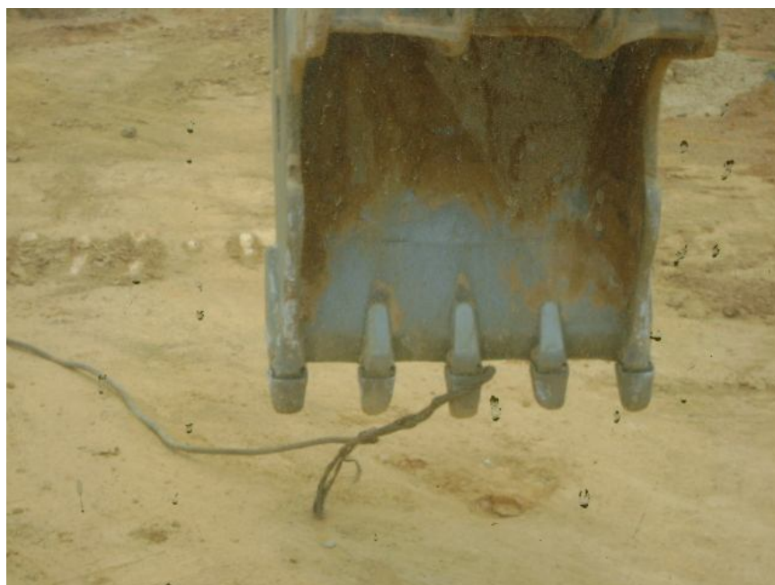
Figura 42 Prende-se a ponta do cabo no dente central da pá da retro-escavadeira, a mesma inicia o movimento de marcha ré. Neste movimento a máquina puxa o cabo e levanta o bloco;
