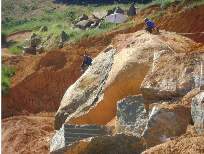
Figura 3 Perfuração de minas. Percebe-se a não utilização das grades protetoras em lugares com risco de quedas.
