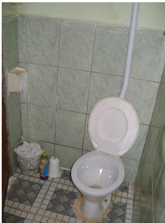
Figura 85 Sanitário destinado ao uso dos trabalhadores da pedreira (julho de 2010).
