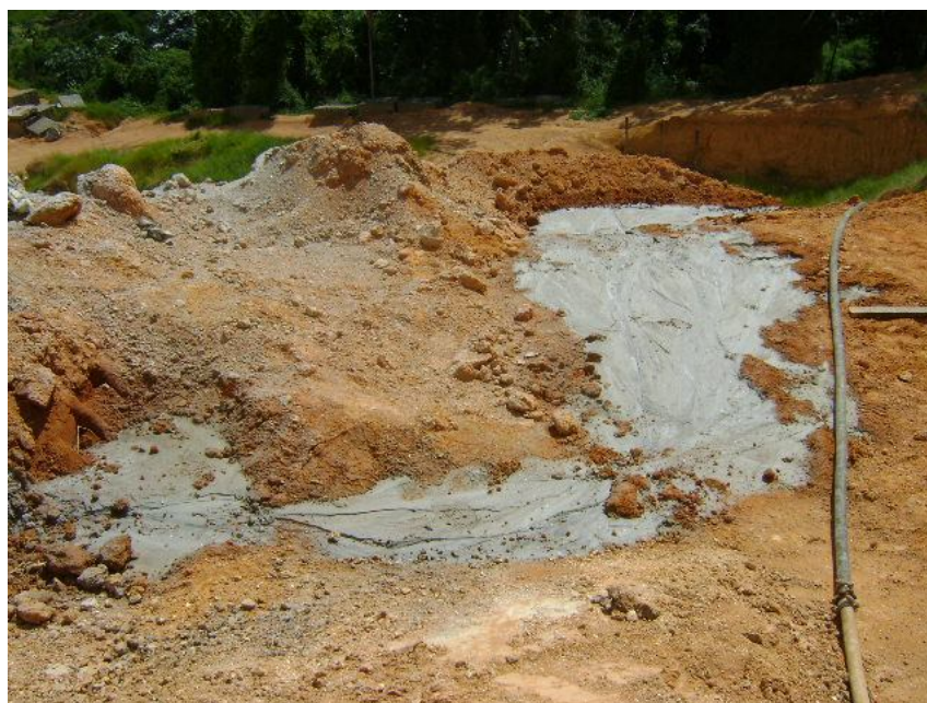
Figura 122 Caminho de escoamento da água dos martelos pneumáticos coberto por pó de sílica.
