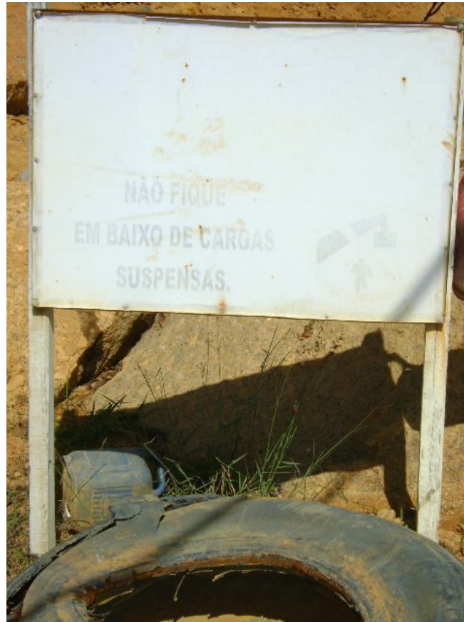
Figura 97 Placa orientando trabalhadores e outras pessoas a não permanecerem embaixo de blocos de rocha suspenso pelo pau-de-carga;
