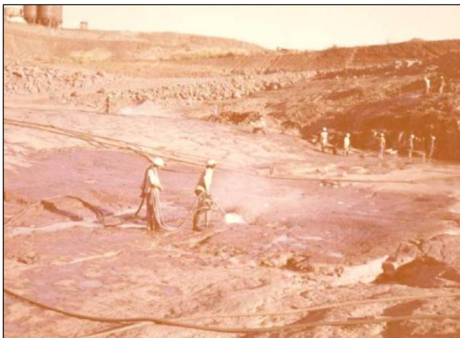
Figura 5.42 – Limpeza de rocha da fundação com jato de água Fonte: CEMIG – GA/SM.
