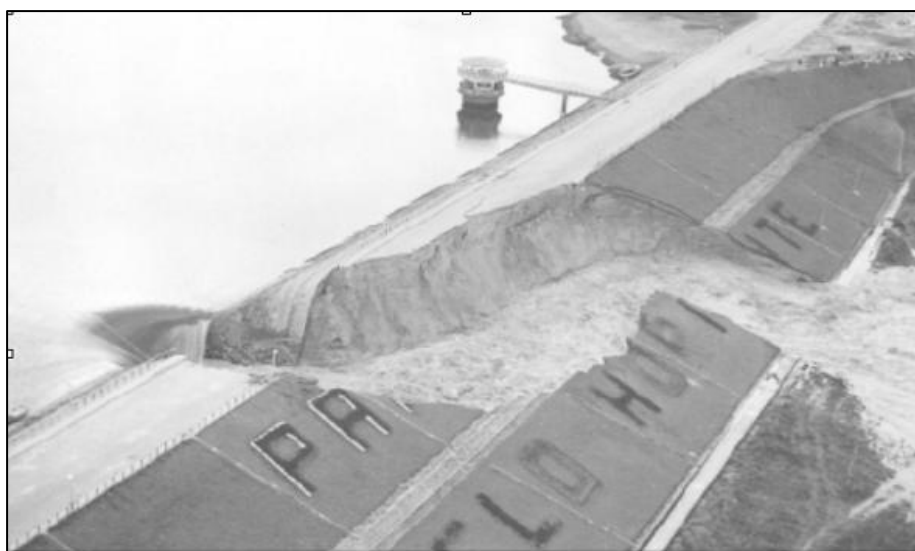
Figura 3.5 – Formação de piping na barragem da Pampulha, Belo Horizonte - MG
