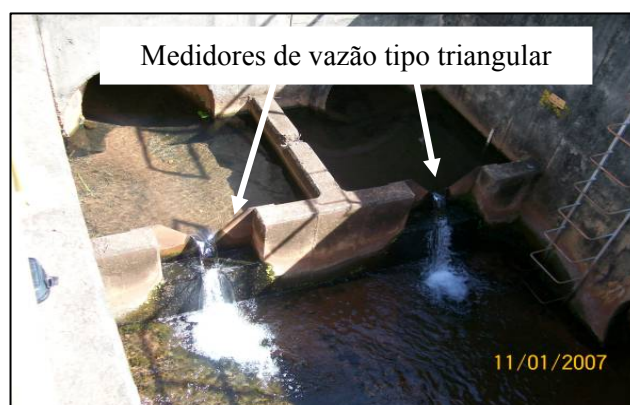
Figura 5.23 – Medidor de vazão VV-005 (margem esquerda)
