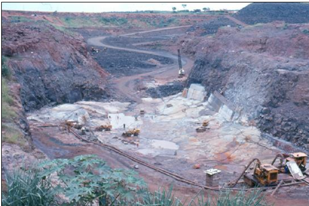
Figura 5.20 – Preparo de fundação no canal do leito do rio Fonte: Modificado de VIOTTI et al. , 2006, p 35.
