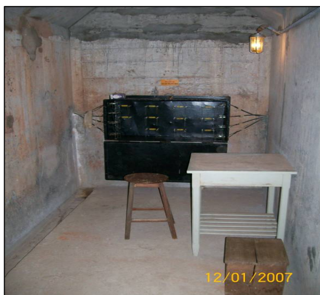
Figura 5.39 – Quadro de Piezômetros Hidráulicos PHs Seção 9 – Transição nº2 – Margem esquerda, galeria de inspeção na elevação 377 m
