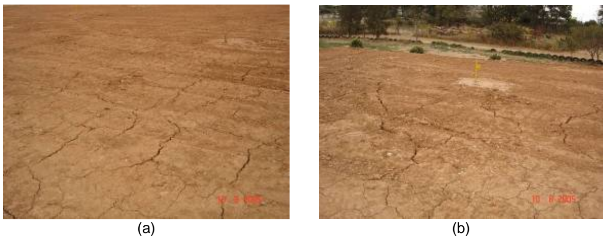
Figura 5.47 - Trincas observadas no topo do Aterro Sanitário Experimental
