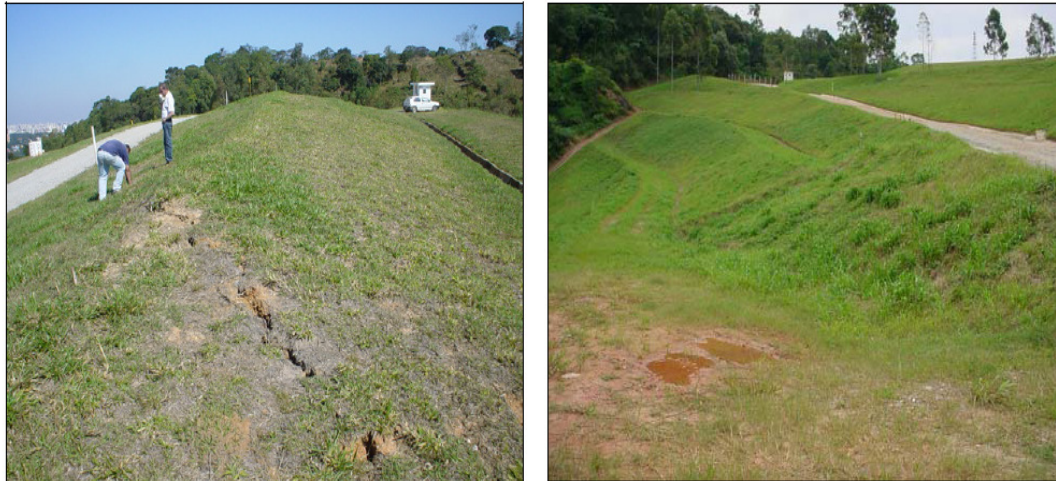
Figura 3.2 – Aspectos anômalos detectáveis por inspeção visual (Jorge et al. , 2004)
