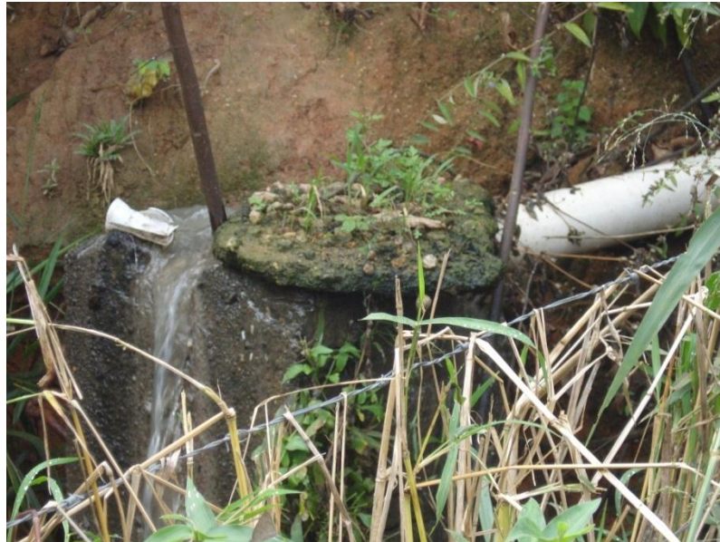
FIGURA 11 - Local em que o esgoto da cidade é despejado no córrego Maranhão
