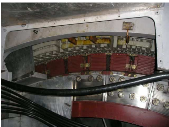
Figura 4.6 – Vista interna do gerador
