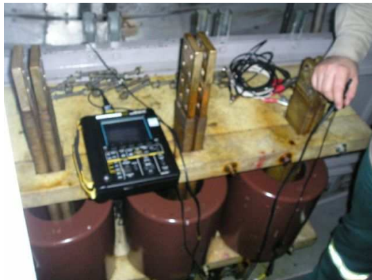
Figura 4.21 – Medição da tensão V3 no terminal de neutro da máquina, com os terminais em aberto, Caso B
