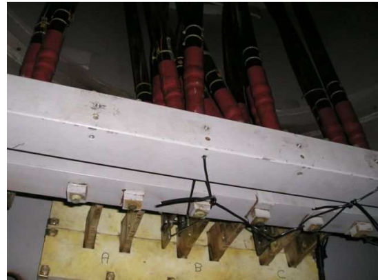
Figura 4.20 – Detalhe dos terminais de fase da máquina com os cabos desconectados, onde foi medida a tensão V2, Caso B
