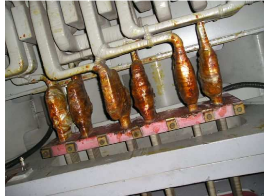
Figura 4.5 – Terminais de fase do gerador
