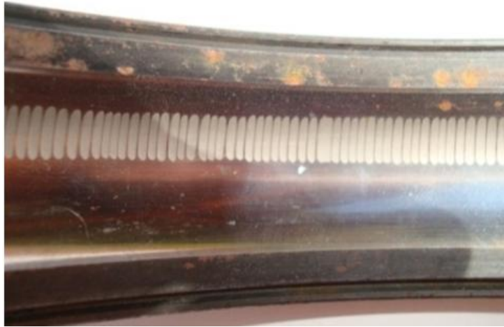
Figura 2.33: Anel externo do rolamento do motor em corte: estrias provocadas por passagem de corrente elétrica.
