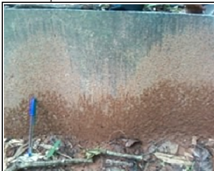
Figura 62 – Demonstração do efeito splash na parede da parcela instalada em área de floresta
