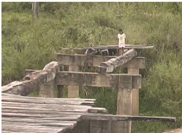
FIGURA 49: Ponte em ruínas sobre o rio Eme – Aldeia Krenak
