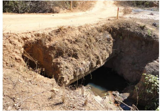
FIGURA 122: Processos erosivos e acúmulo de detritos no escoamento no desvio de água. FOTO: RODRIGUES, 2011.
