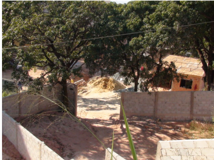
Figura 15: Obras irregulares em Área de Preservação Permanente de nascentes, causando desestabilização de encosta
