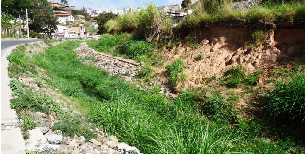
Figura 17: Diversos pontos de erosão nas margens do córrego Prentice Coelho
