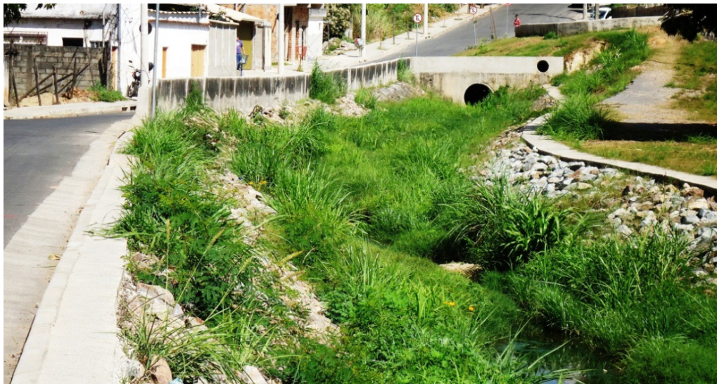
Figura 18: Assoreamento e falta de manutenção no córrego Prentice Coelho
