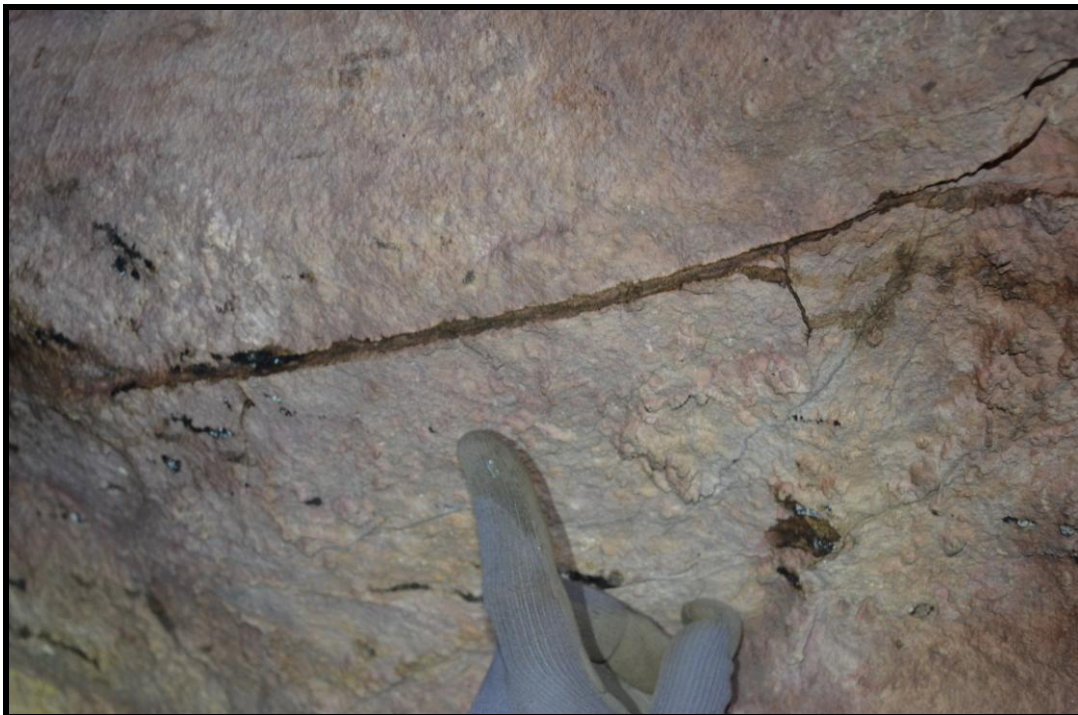
Figura 32: Pequena fratura no teto da Gruta Monte Cristo por onde a água infiltra no substrato rochoso, dando início ao processo de alteração.(Autor: Alessandra Vasconcelos, 2014)
