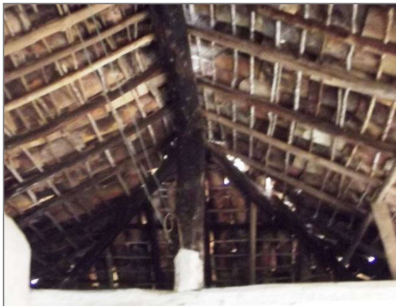
Figura 184: Encaixe do eixo Principal com a terceira água do telhado (à leste). FOTO: SILVA (2016)
