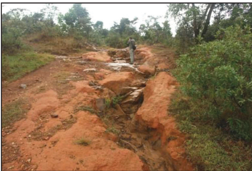
Figura 32 - Estrada erodida nas proximidades da cachoeira do Viana.
